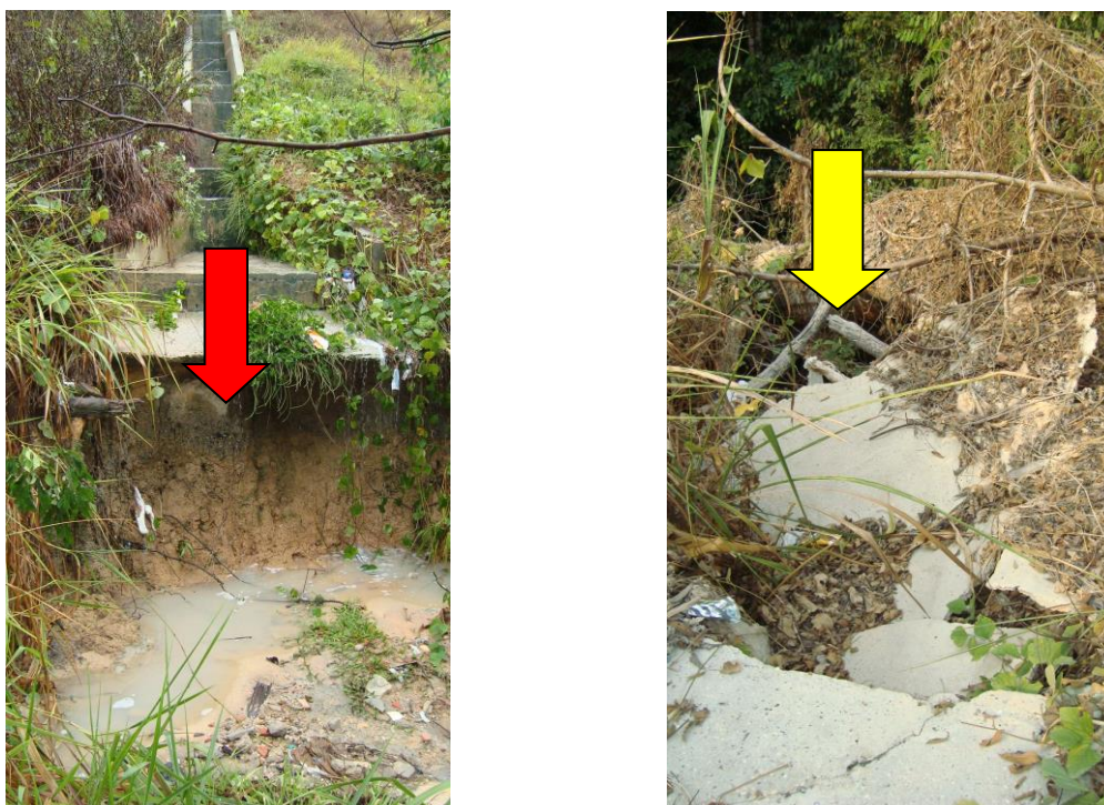
Figura 2 -Quebra da parte final da estrutura 10 (seta vermelha) e estrutura 11 (seta amarela) propicia a formação de feições erosivas. Foto de Antonio F.G.Vieira (09/10/2009).
