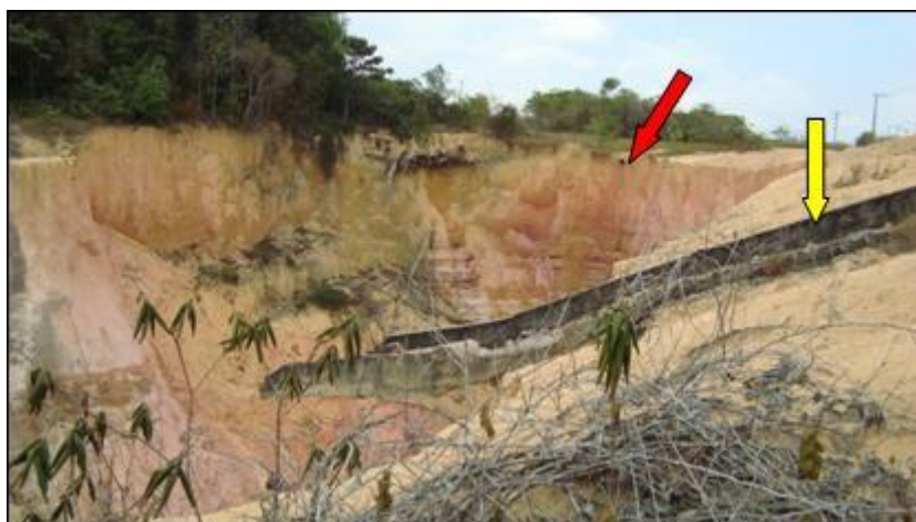
Figura 4 - Vista em direção a montante da voçoroca 9. Seta vermelha aponta para saída d'água na forma de tubos de 100 mm de diâmetro. Seta amarela aponta para a canaleta. Distrito Industrial 2 – Manaus (AM). 12/09/09
