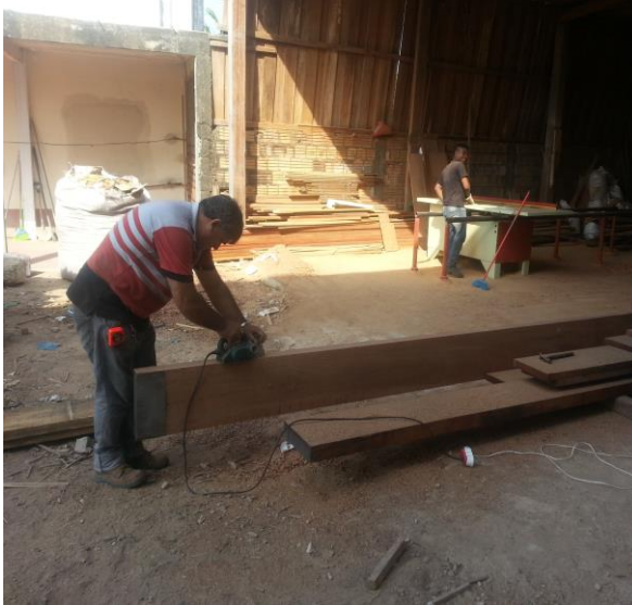
Figura 3 – Trabalhador sem EPI's.
