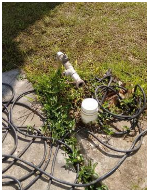
Figura 13- Poços desativados com proteção Fonte: Madalena. Epifânio Marques. Data 08/12/2012
