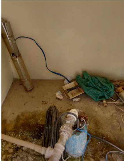
Figura 06- Bomba submersa de poços tubulares Fonte: Madalena E. Marques: 03/12/2013
