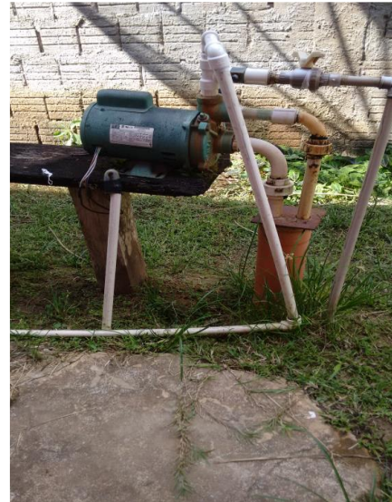
Figura 07 - Bomba injetora de poços tubulares Fonte: Madalena E. Marques: 03/12/2013
