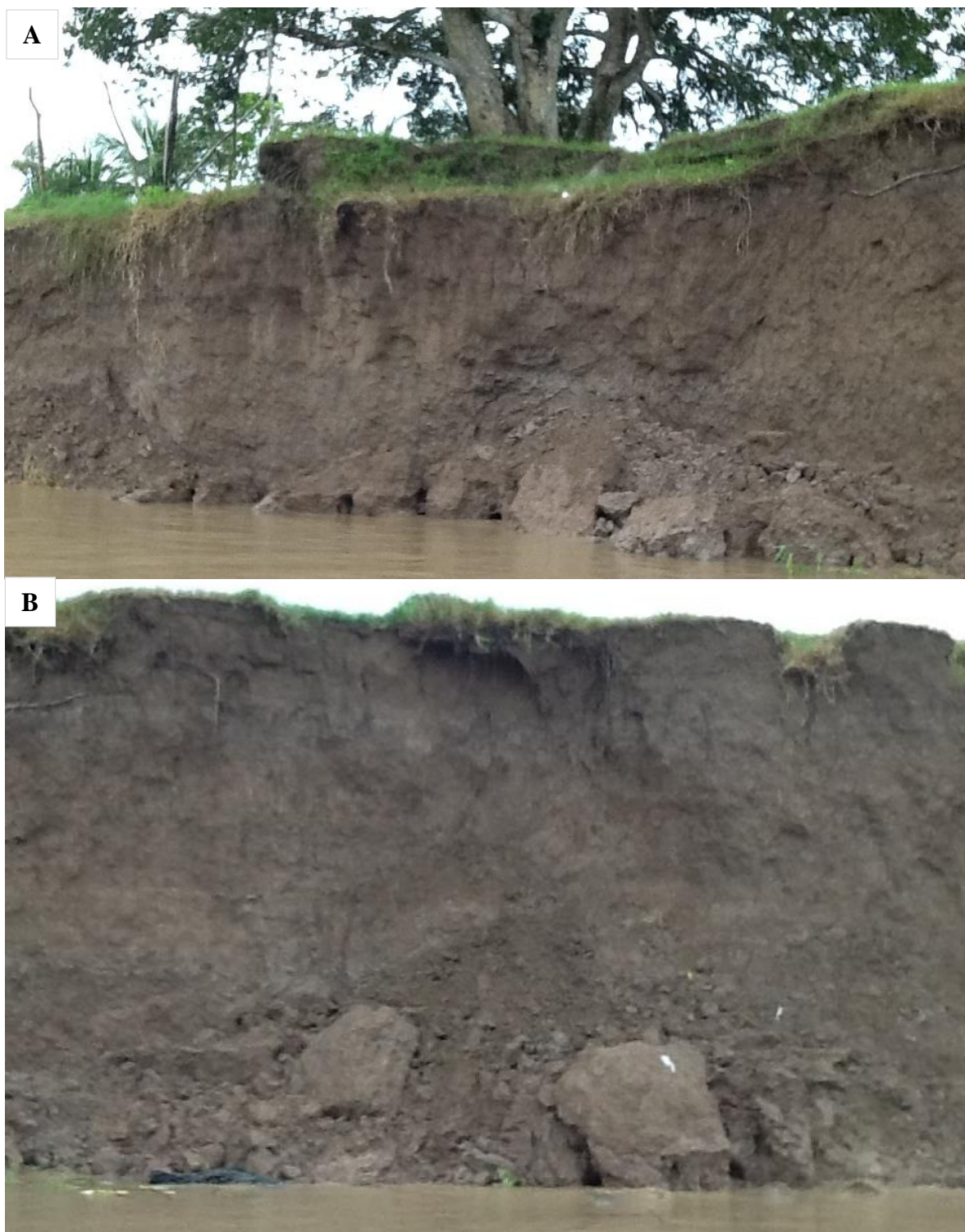
Figura 04: Erosão (terras caídas) margem esquerda do Paraná do Careiro – Comunidade Miracauera. Organização: Evelin Ribeiro/2014.
