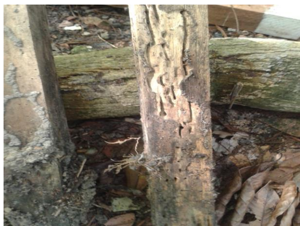
Figura 11: Exemplo de danos causados pelos térmitas às estacas de madeira.
