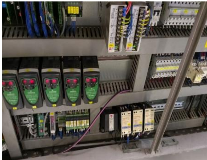
Figura 33 Instalação do Relé e Contactora
