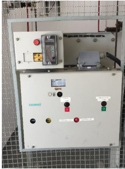
Figura 34 - Disjuntor geral de média tensão acompanhado de um relé 50/51.
