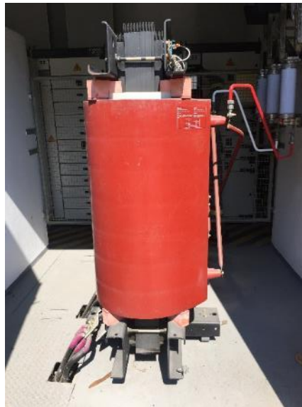
Figura 35 - Posto de transformação contendo um transformador a seco.
