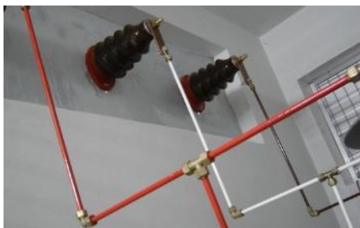
Figura 12 - Bucha de passagem e derivação para medição.
