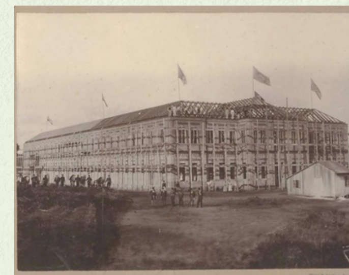
Fig. 11 - Construção do Hospital Psiquiátrico Nossa Senhora da Luz - Curitiba (PR). Fonte: Gazeta do Povo.
