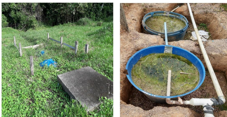
A – Sistema filtro aeróbio antes da locação do SACV; B – Sistema alagado construído implantado no lugar do filtro aeróbio em operação.
