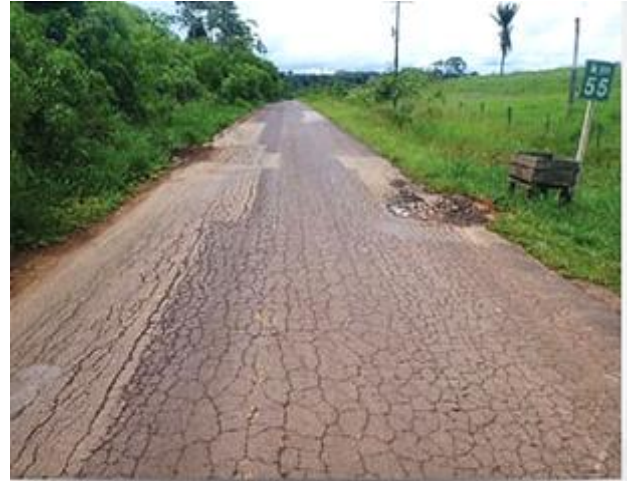
Figura 16b - Exemplo de trinca couro de jacaré sem erosão
