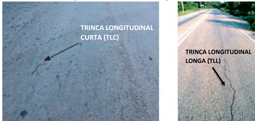
Figura 14 - Exemplos de trincas longitudinais
