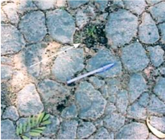
Figura 16a - Exemplo de trinca couro de jacaré com erosão nas bordas
