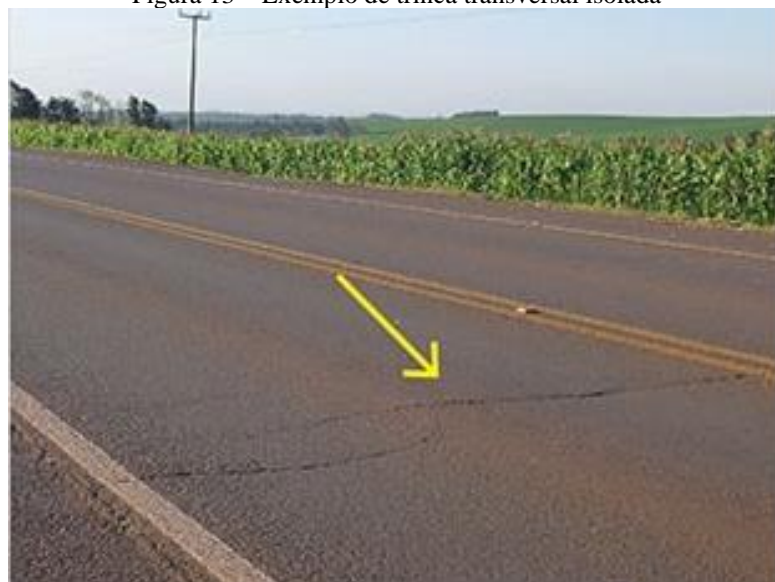
Figura 13 – Exemplo de trinca transversal isolada
