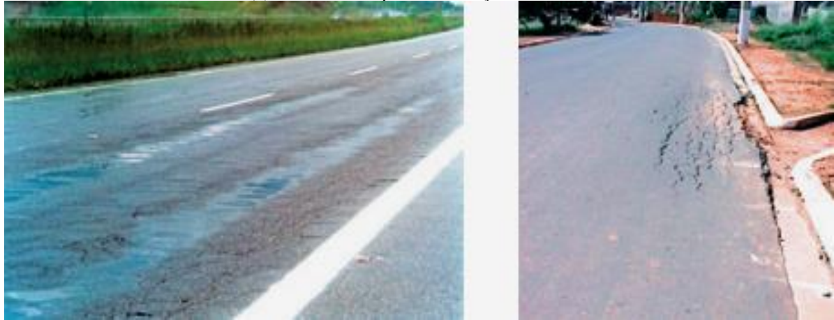
Figura 19 – Exemplos de (a) Afundamento por consolidação em trilha de roda e (b) Afundamento por consolidação localizado
