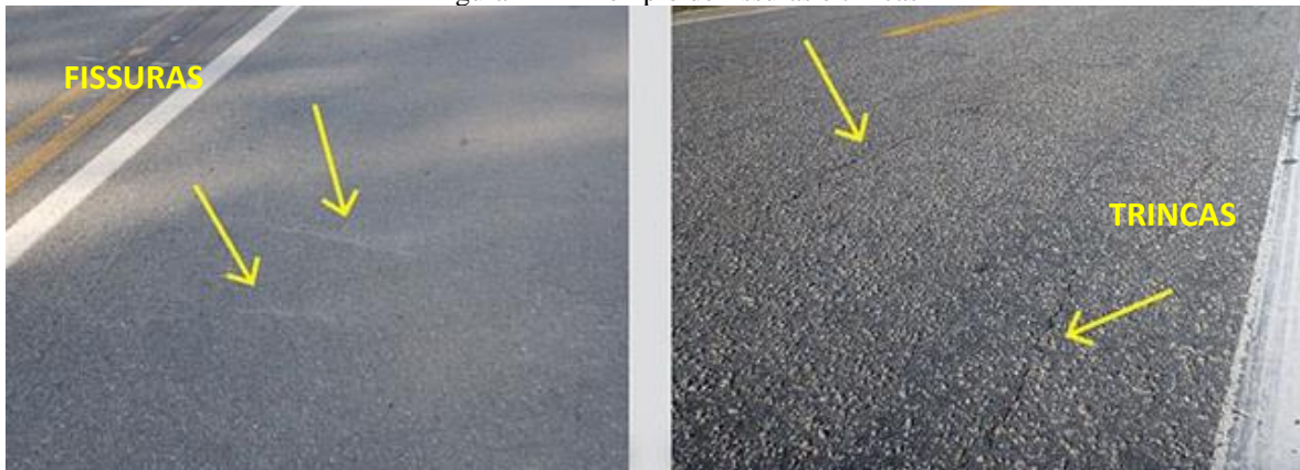
Figura 12 – Exemplo de fissuras e trincas
