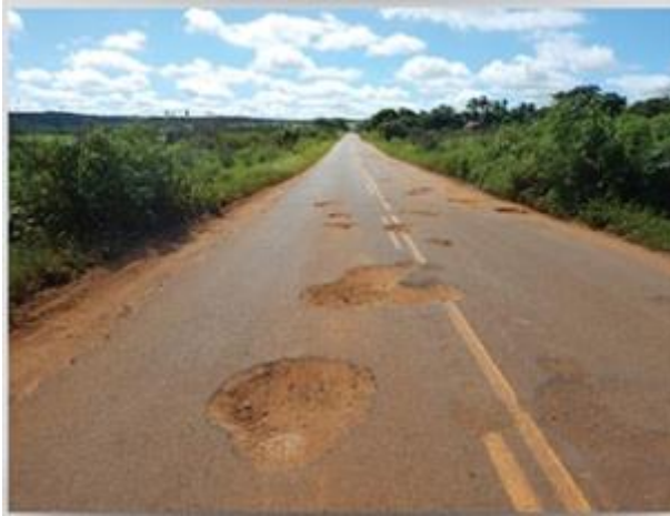
Figura 23 – Exemplo de panela profunda, com danos a base
