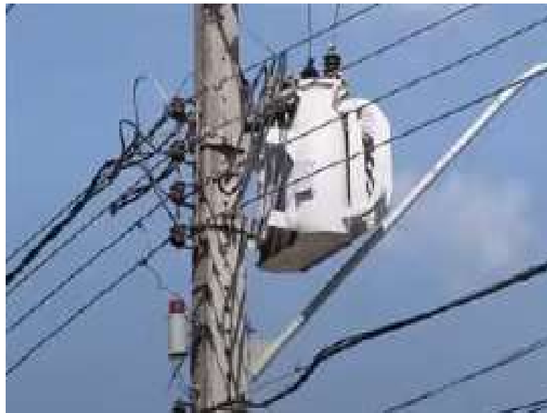
Figura 3 – Fiação B da distribuidora de energia.
