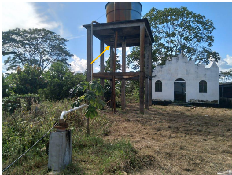
Figura 9 -Sistema de distribuição da água de poço da comunidade Costa da Conceição
