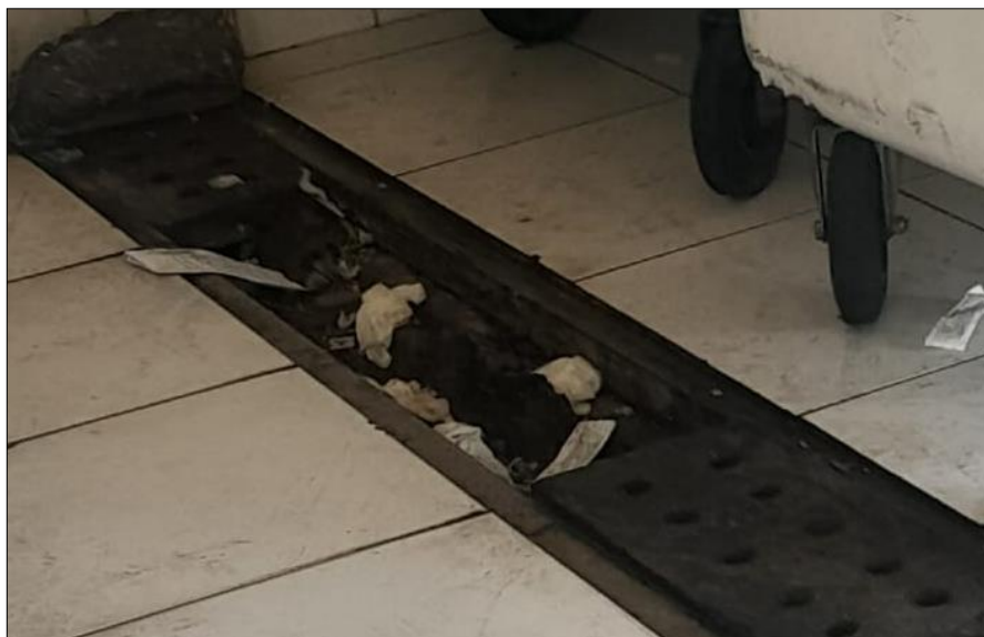
Figura 33 - Resíduos do grupo A e D obstruindo o ralo do abrigo.
