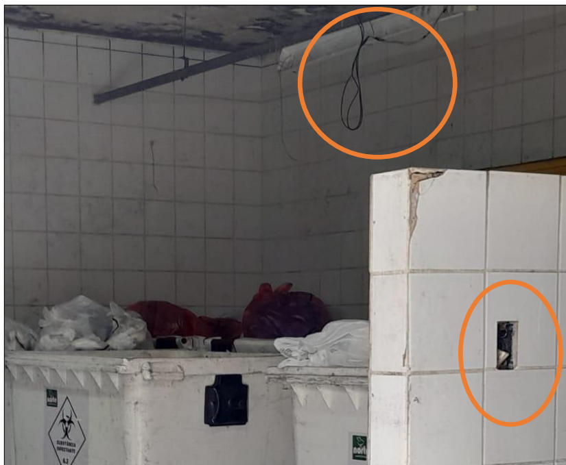
Figura 27 - Fiação exposta e tomadas necessitando de reparos.
