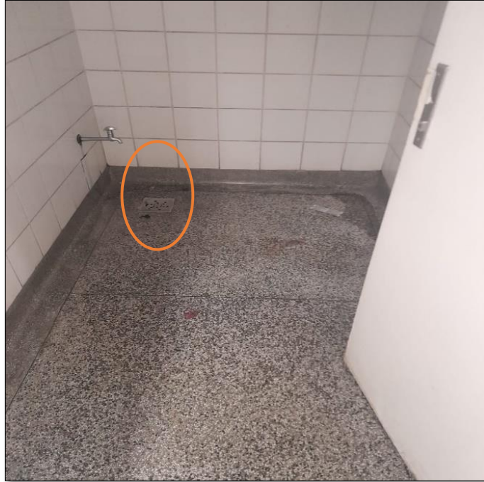
Figura 20 - Ralo obstruído do abrigo temporário.
