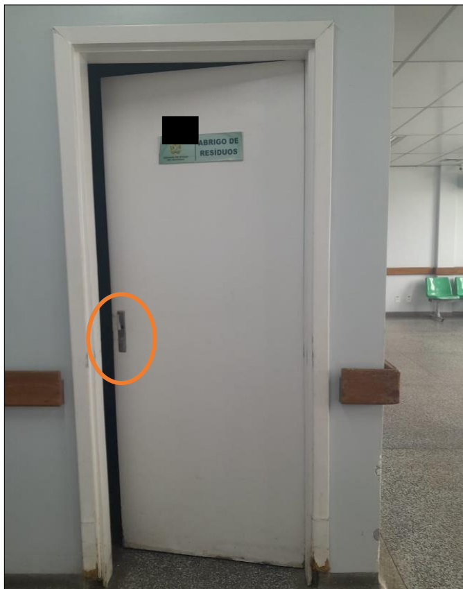
Figura 19 - Ausência de fechadura na porta do abrigo temporário.
