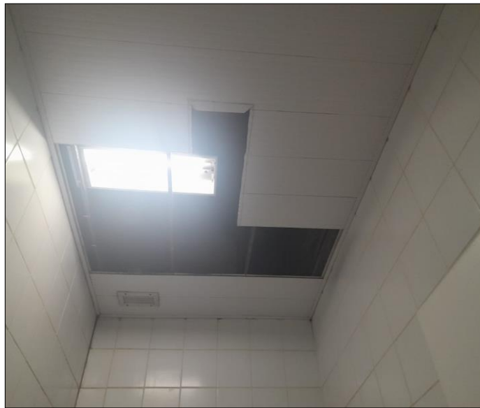
Figura 21 - Forro PVC necessitando de manutenção.
