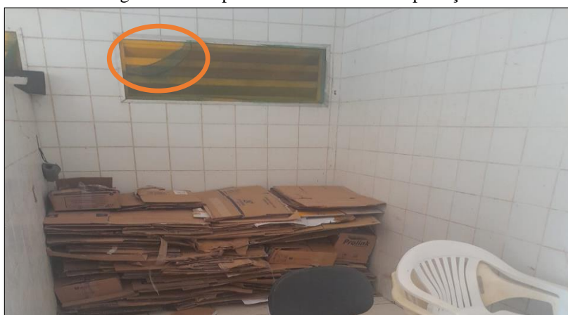
Figura 28 - Desprendimento das telas de proteção.
