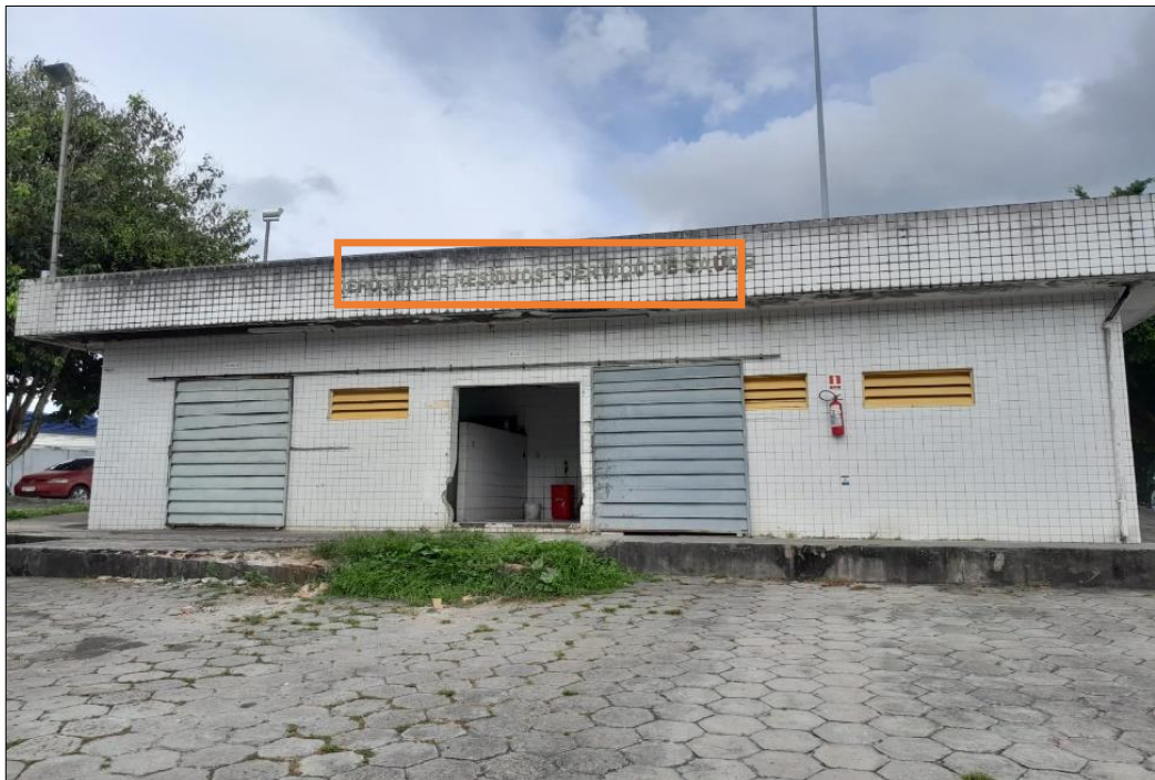
Figura 25. Letreiro e iluminação externa necessitando de manutenção.
