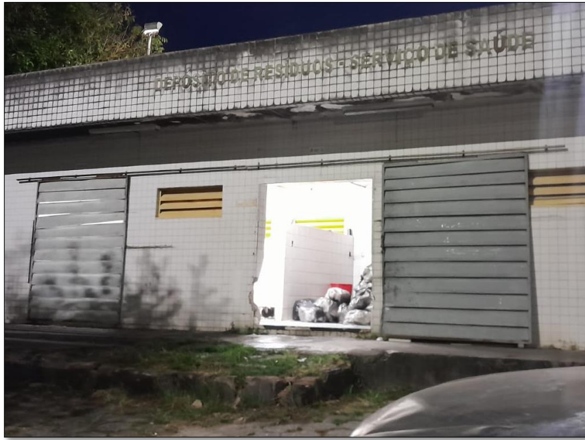
Figura 26 - Porta de acesso necessitando de manutenção.
