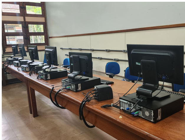
Figura 4.10 – Após organização dos cabos
