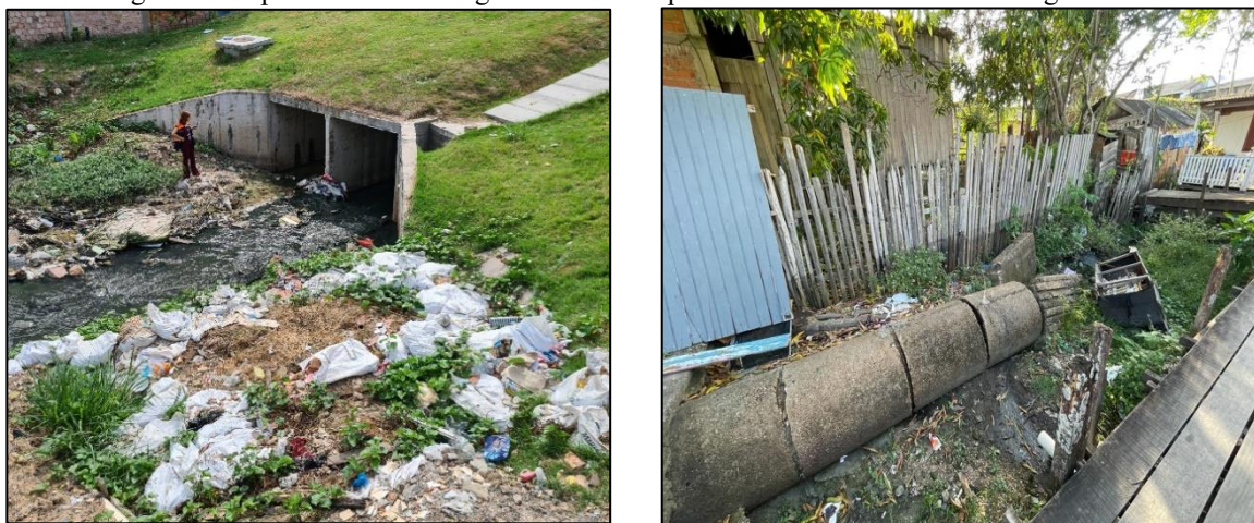
Figura 3 - Expansão urbana irregular e as consequências sobre sistemas de drenagem.
