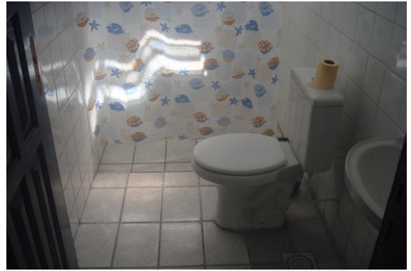
Figura 16 – Banheiro da SRM inadaptado. (Fonte: Vinente, 2012)
