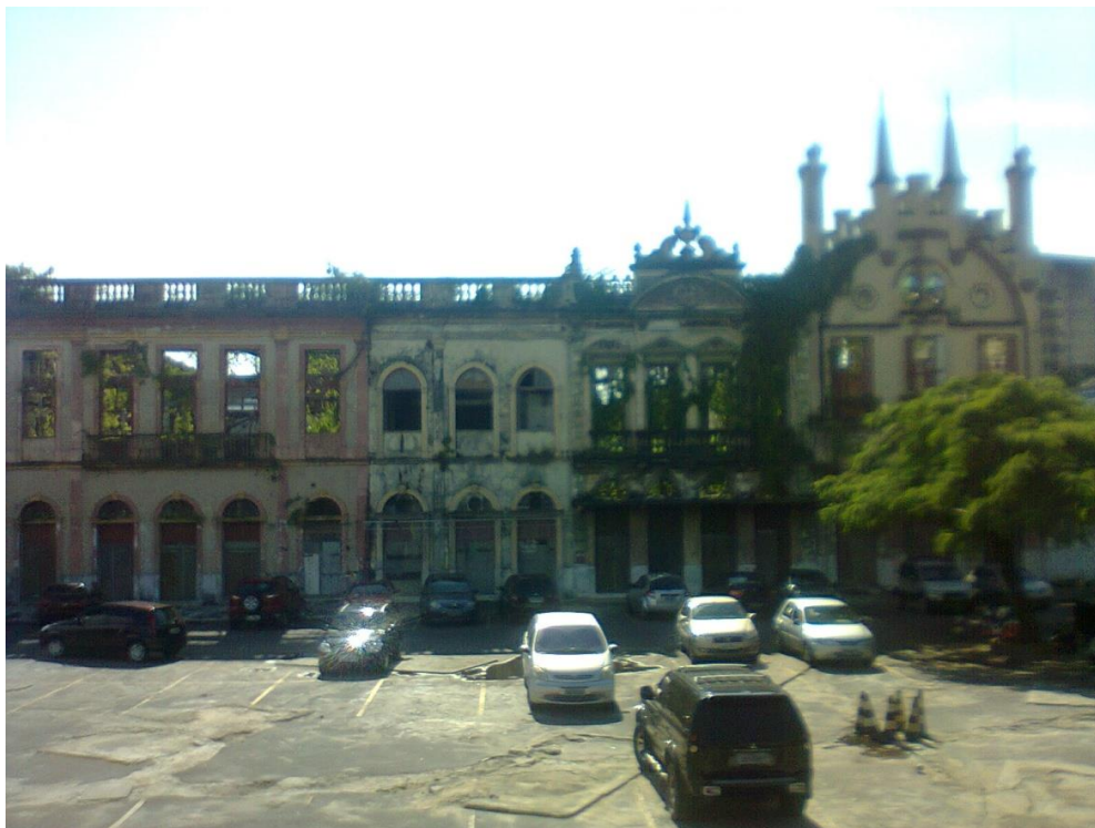
Figura 2. Abandono estruturas que variam de casa à estabelecimentos comerciais, que funcionaram plenamente no ciclo da borracha, e na atualidade algumas dessas construções encontram-se deterioradas. Fonte: Thiago O. Neto (18/04/13)
