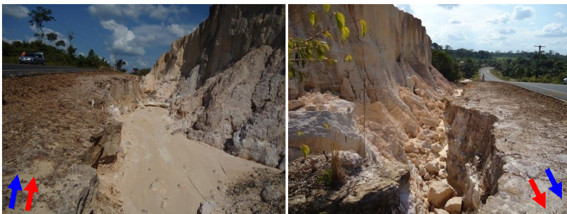
Figura 14: Voçoroca 7. Primeiro monitoramento. As setas em azul e vermelho indicam, respectivamente, a pista e o sentido do crescimento da incisão. Fotos: Deiziane, novembro/2012.
