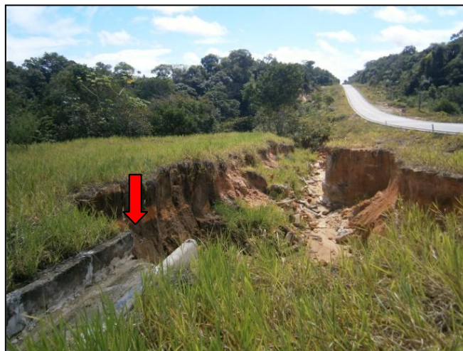
Fig. 29 – Nova incisão do km 56,1, originada pela canaleta (seta vermelha).
