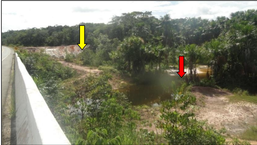
Fig. 33 – Vale assoreado (seta vermelha), voçoroca do tipo conectada ao vale (seta amarela), forma dendrítica. BR-174 km 45.
