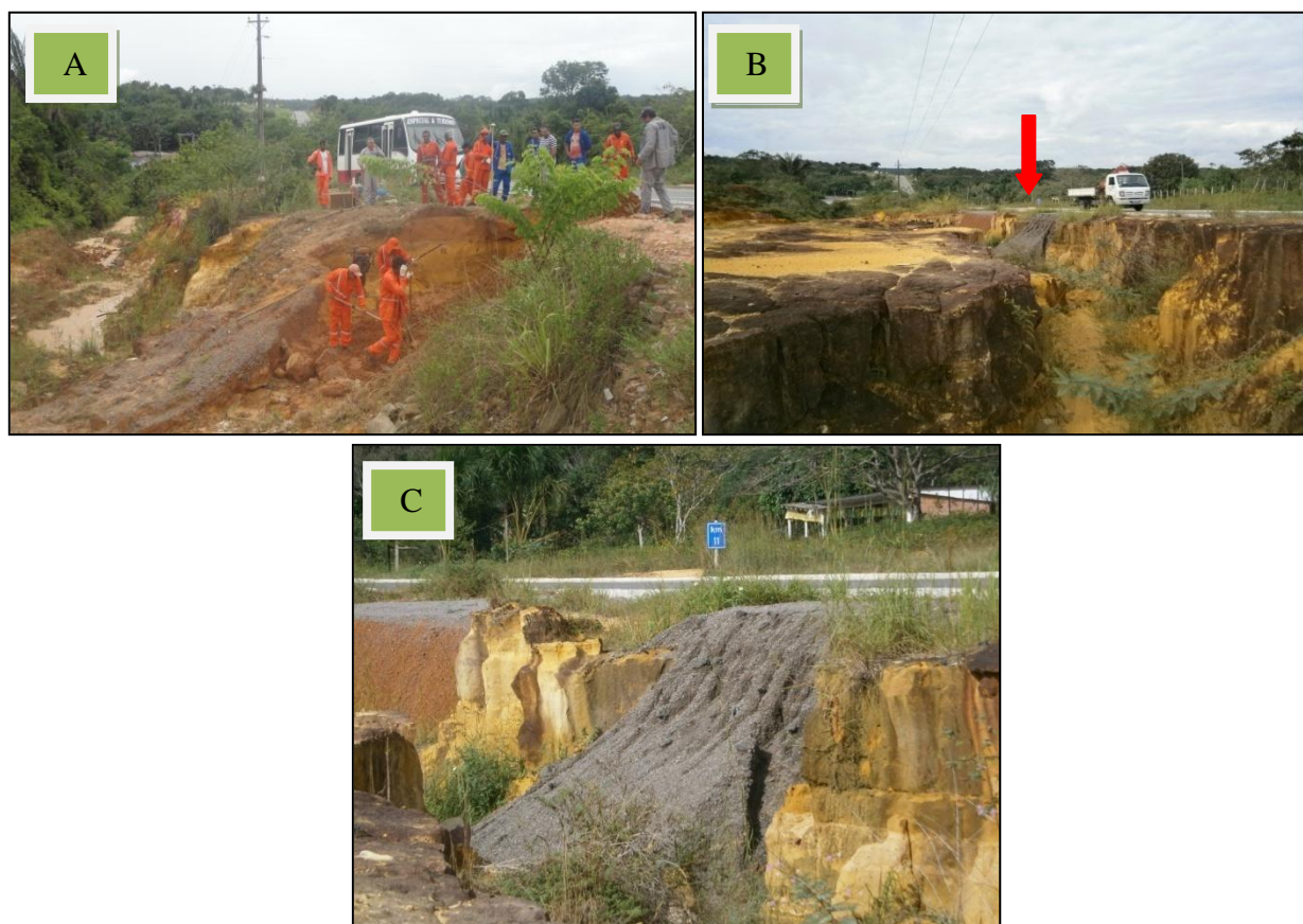
Fig. 27 – Figura (A), voçoroca do km 11 sendo contida pelo DNIT; Figura (B), km 11 incisão contida pelo DNIT (seta vermelha); Figura (C) material de aterro para a contenção da incisão. Fonte: Letícia da S. Lima 17/01/2013 e 13/06/2013.
