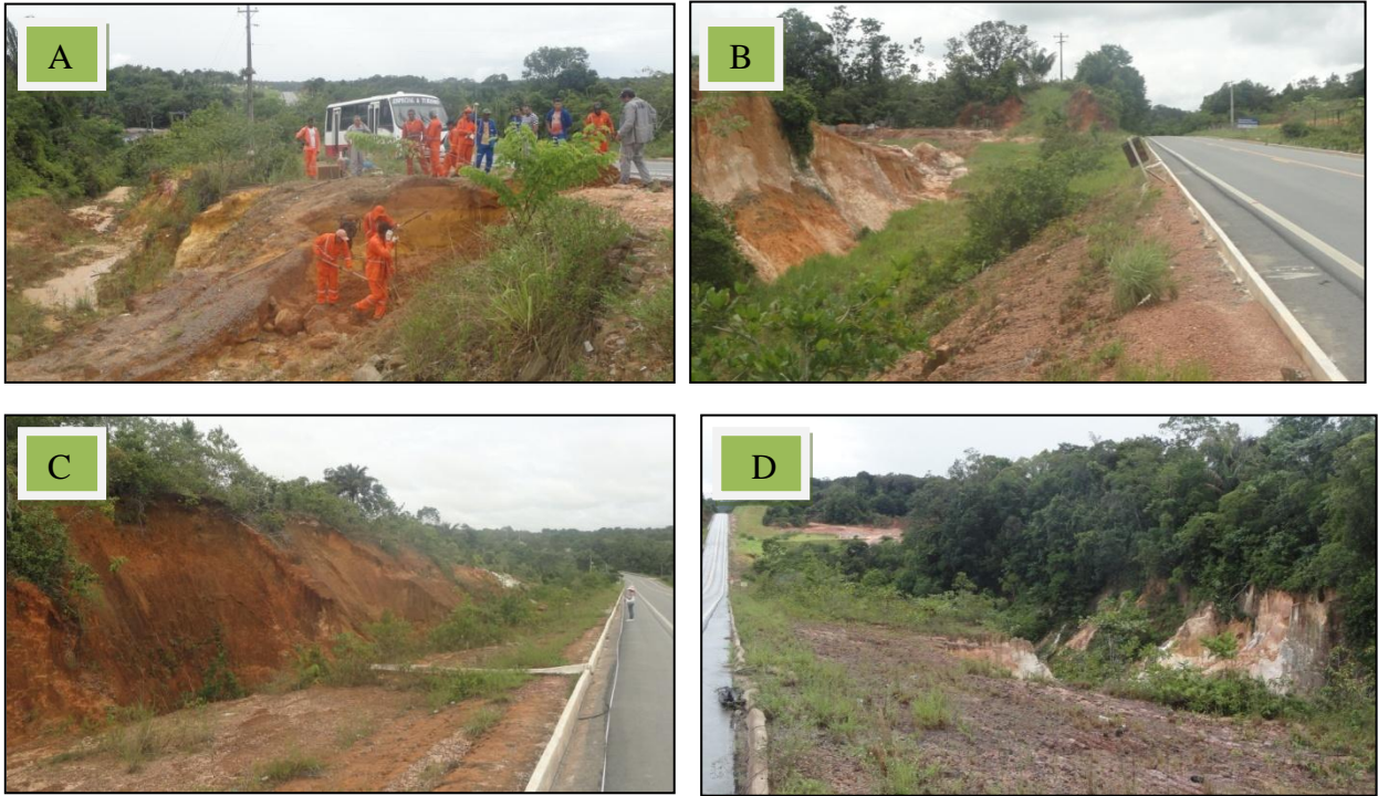
Fig. 23 - (A) Nível 1 Risco Imediato, voçoroca km 11; (B) Nível 2 Risco a curto prazo, voçoroca km 24; (C) Nível 3 Risco a médio prazo, voçoroca km 06; (D) Nível 4 Risco a longo prazo, voçoroca km 56,2.
