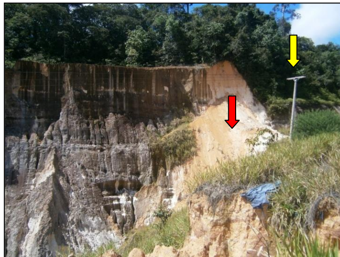
Fig. 35 – Poste (seta amarela) próximo a voçoroca (seta vermelha) com risco de queda km 52. Fonte: Letícia da Silva Lima 13/06/2013
