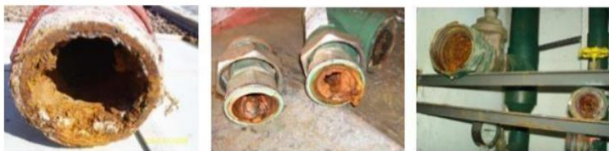
Figura 10 - Tubulações com presença de incrustações
