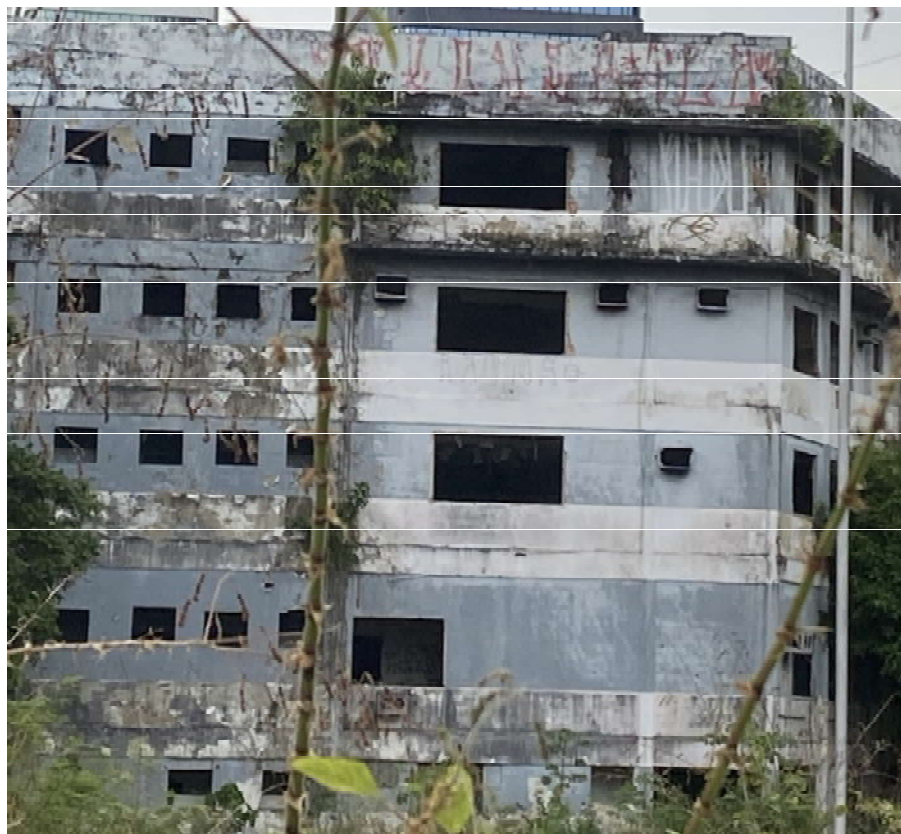
Figura 55 – Infiltrações no Edifício da antiga ISAE.
