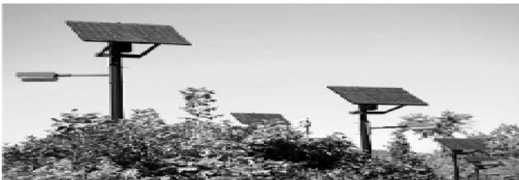
Figura 18: Postes de iluminação autônomos alimentados por módulos fotovoltaicos
