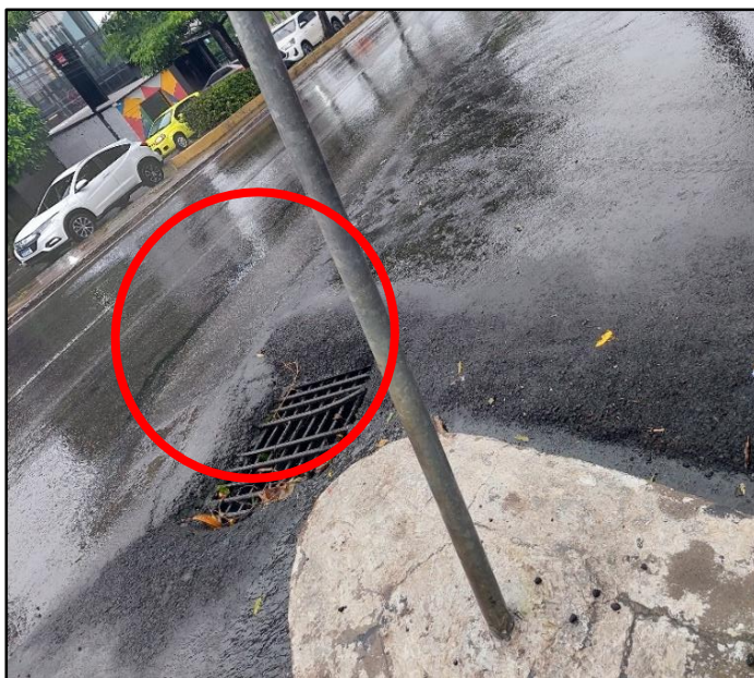
Figura 30: Boca de lobo engolida pela pavimentação
