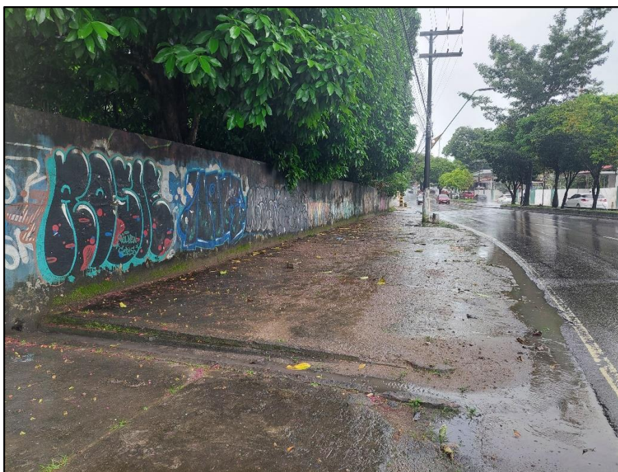
Figura 21: Meio- Fio Inexistente
