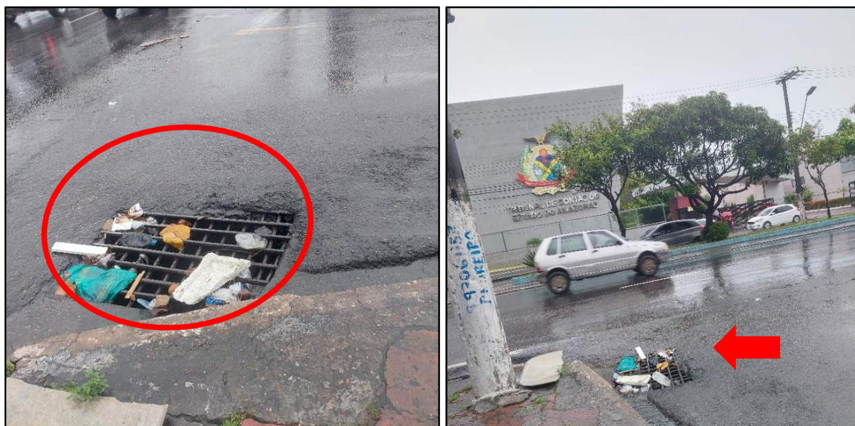
Figura 27: Boca de lobo sem manutenção.
