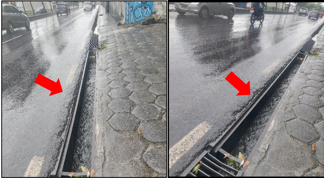
Figura 23: Sarjeta descaracterizadas e uso de grades.
