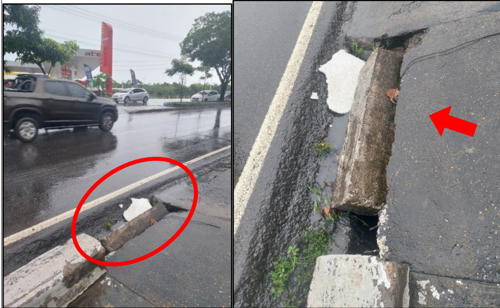
Figura 28: Bocas de lobo deterioradas
