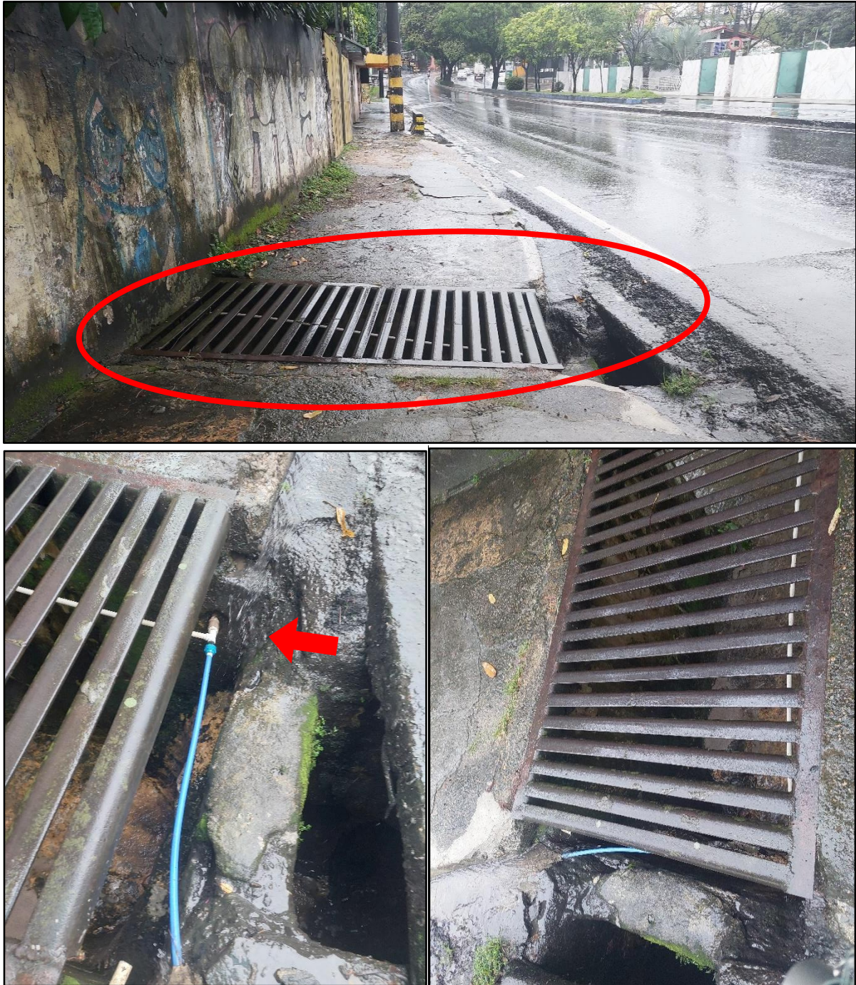
Figura 32: Condição existente no Canal de drenagem localizado na avenida.
