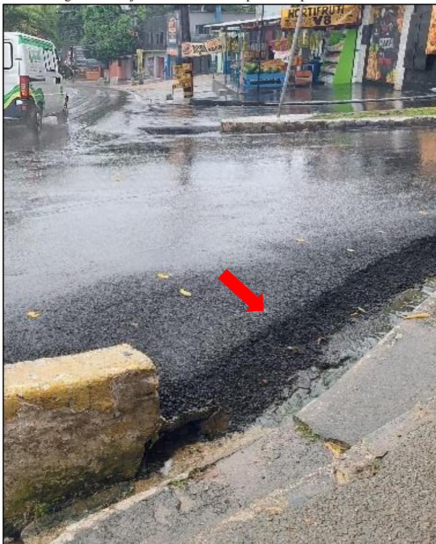
Figura 22: Sarjeta descaracterizada pelos recapeamentos da via.
