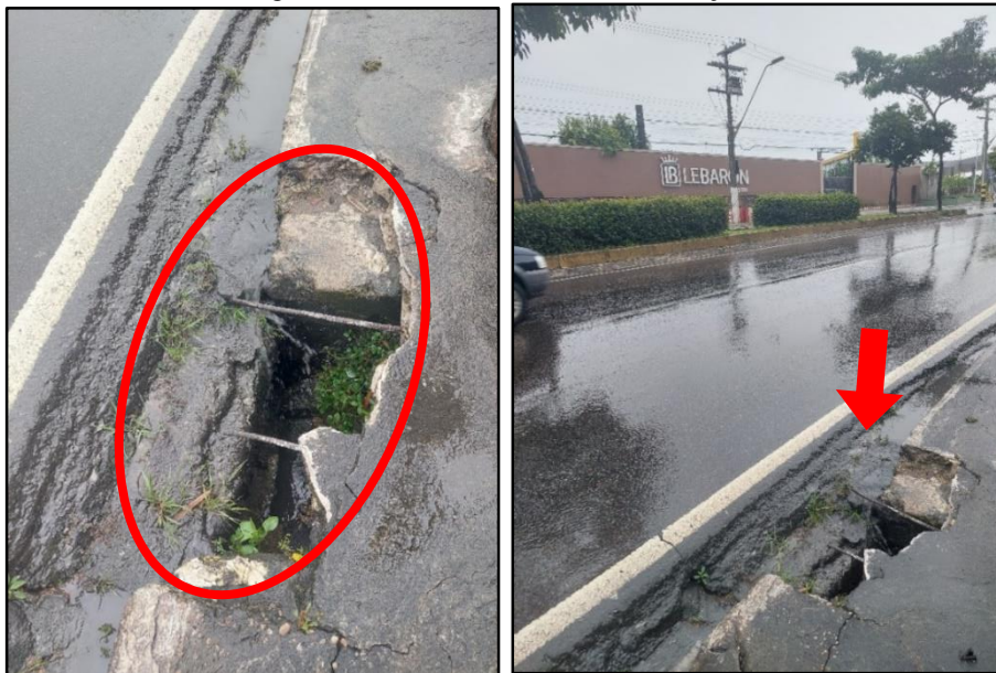
Figura 29: Ocorrências de má conservação das Bocas de lobo
