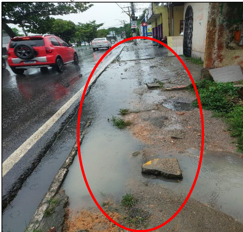
Figura 25: Passeio Público danificado
