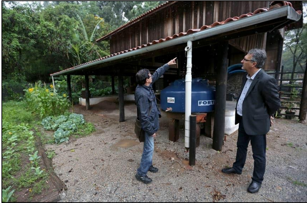
Figura 36: Sistema de Captação em Osasco/SP
