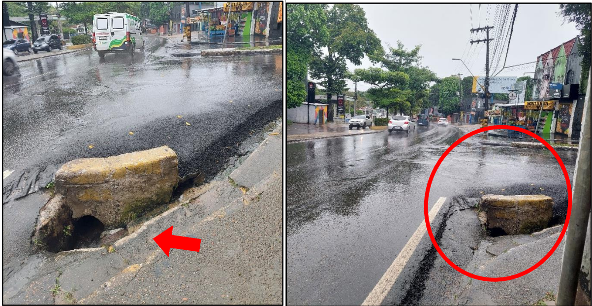
Figura 31: Localização da Boca de lobo em local inadequado.
