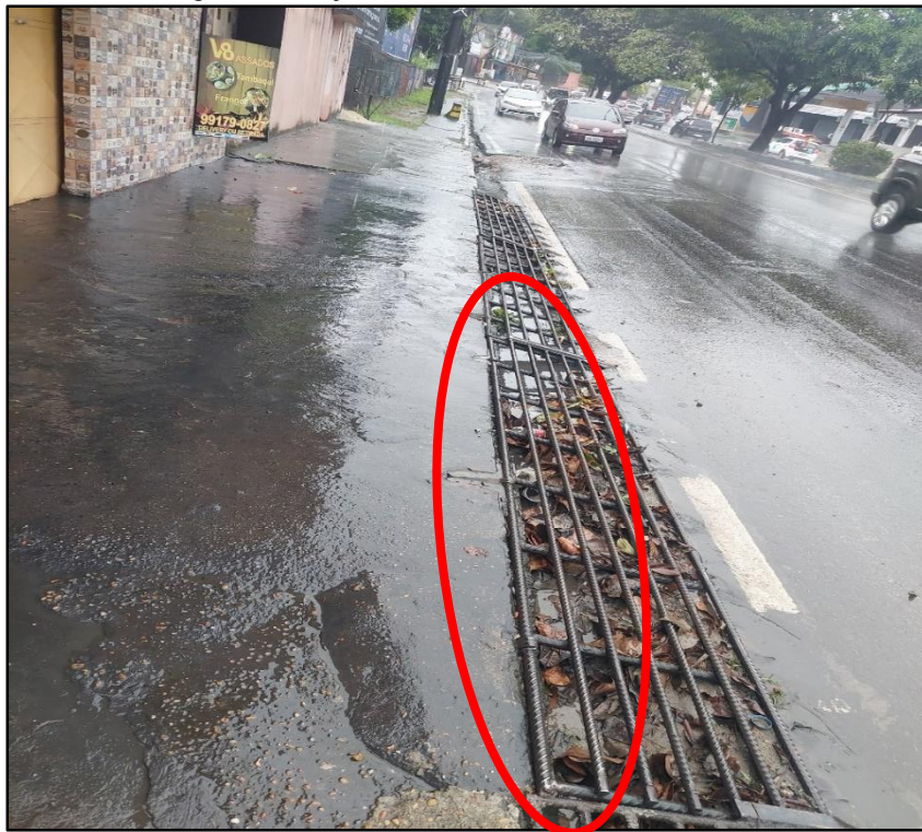
Figura 24: Sarjeta com acúmulo de resíduos sólidos
