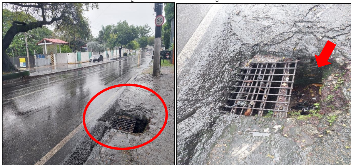
Figura 26: Boca de Lobo irregular
