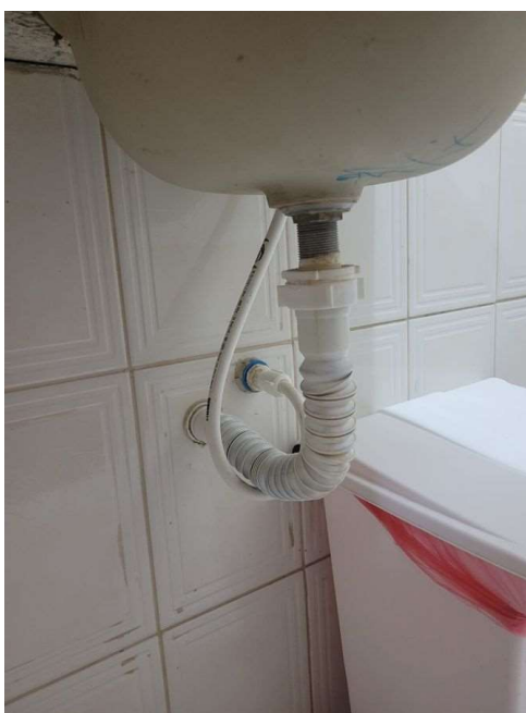
Figura 30 — Sifão do banheiro masculino da sala 2
