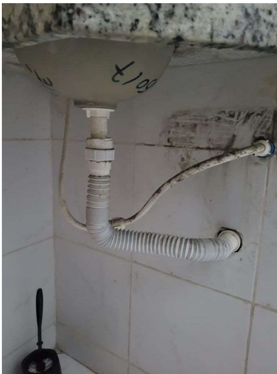
Figura 34 — Sifão sanfonado do banheiro masculino
