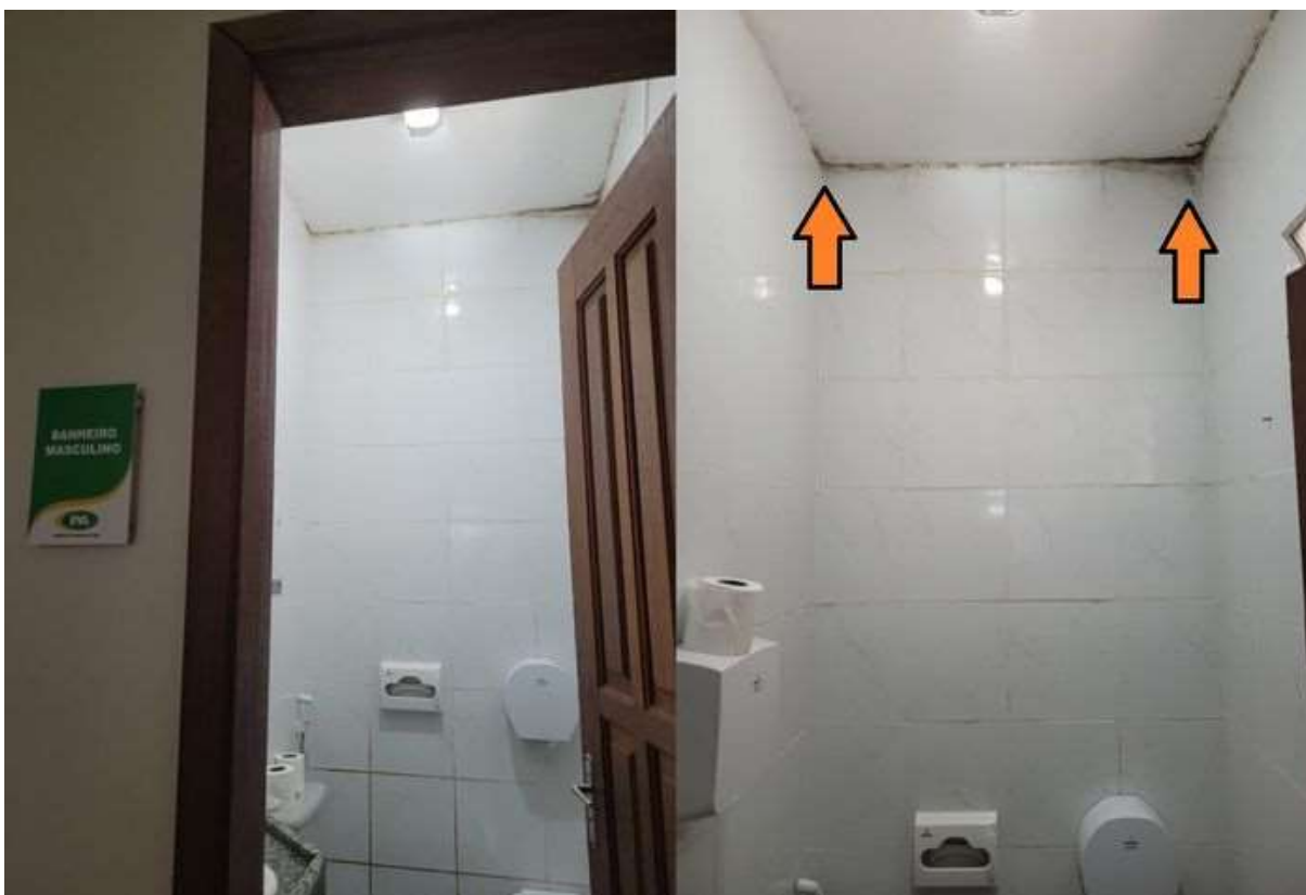
Figura 35 — Manchas com umidade no banheiro masculino do primeiro pavimento
