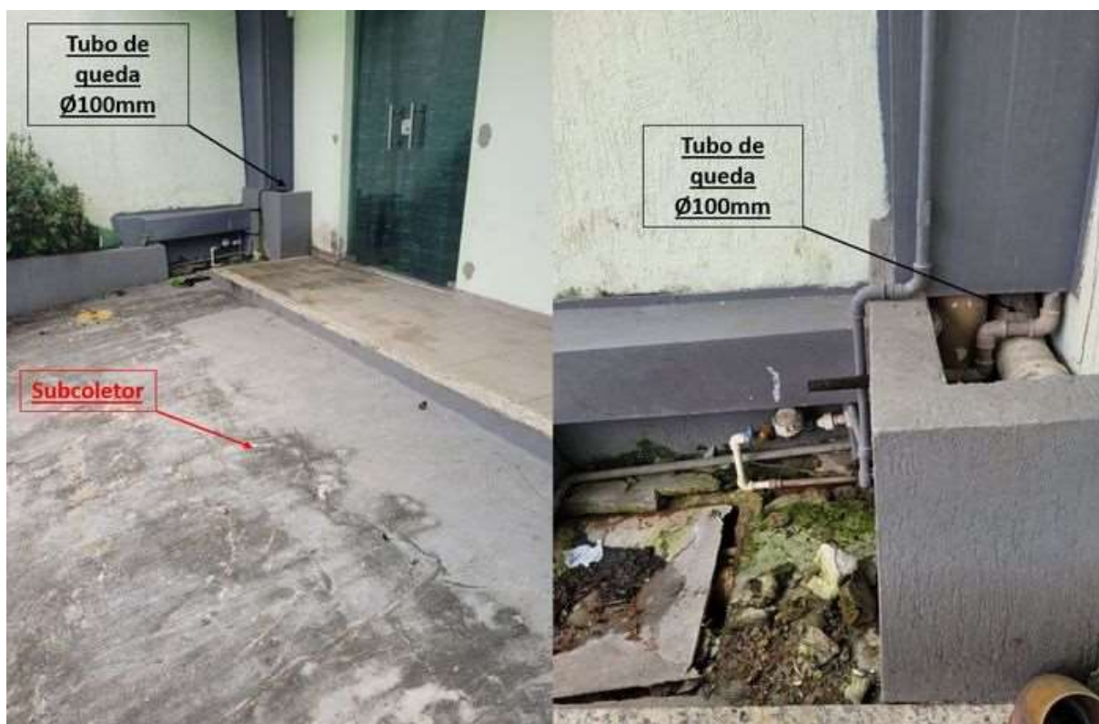
Figura 52 — Tubo de queda e subcoletor
