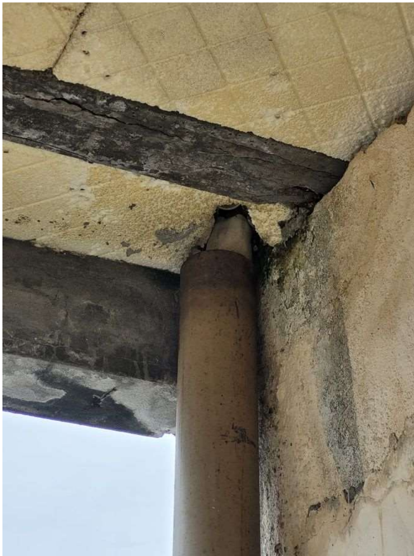
Figura 48 — Não conformidade no tubo de queda de gordura
