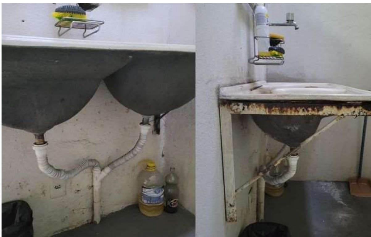
Figura 42 — Sifão sanfonado do tanque duplo do poço de ventilação do pavimento térreo
