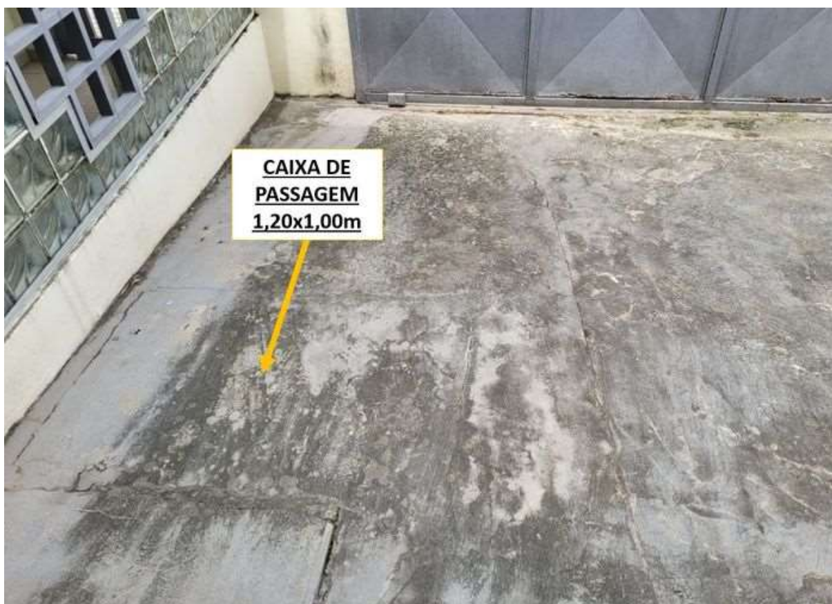
Figura 51 — Caixa de passagem da Garagem
