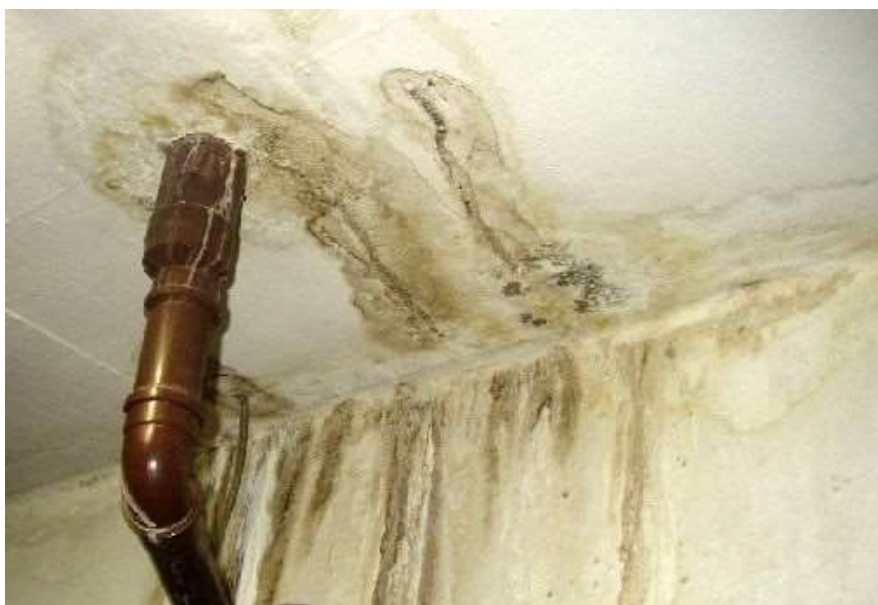
Figura 4 — Manchas de umidade na parede
