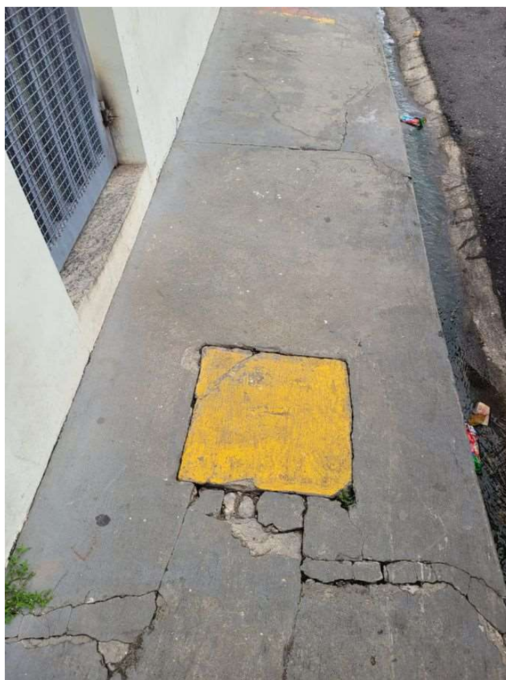
Figura 55 — Caixa de inspeção no passeio
