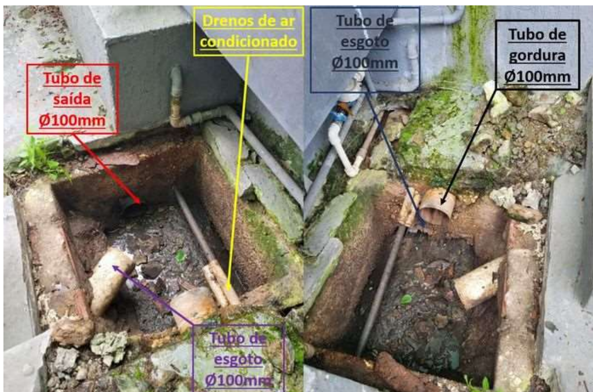
Figura 54 — Caixa de inspeção
