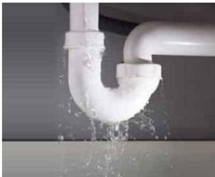
Figura 5 — Vazamento em sifão
