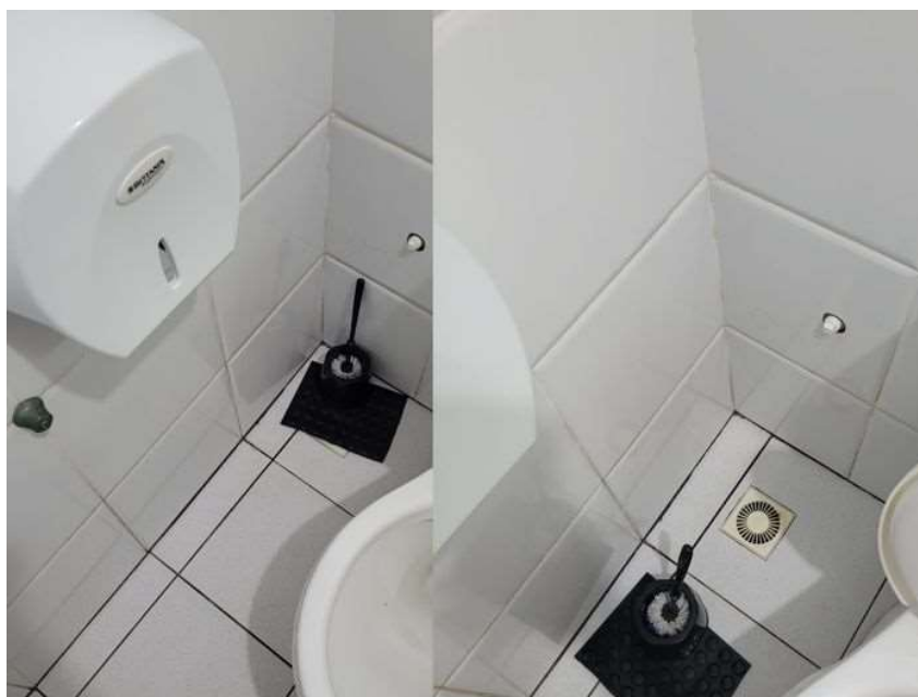
Figura 59 — Prática adotada para evitar retorno de gases pelo ralo
