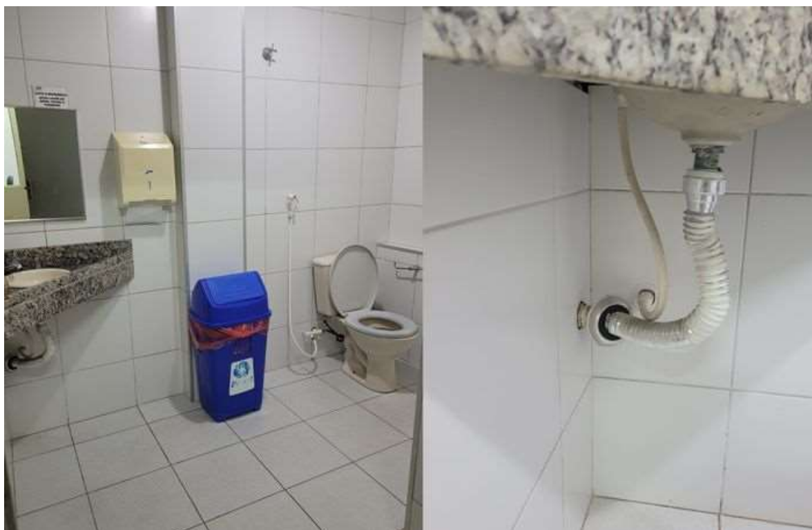
Figura 41 — Sifão sanfonado do lavatório do banheiro feminino/PNE do pavimento térreo
