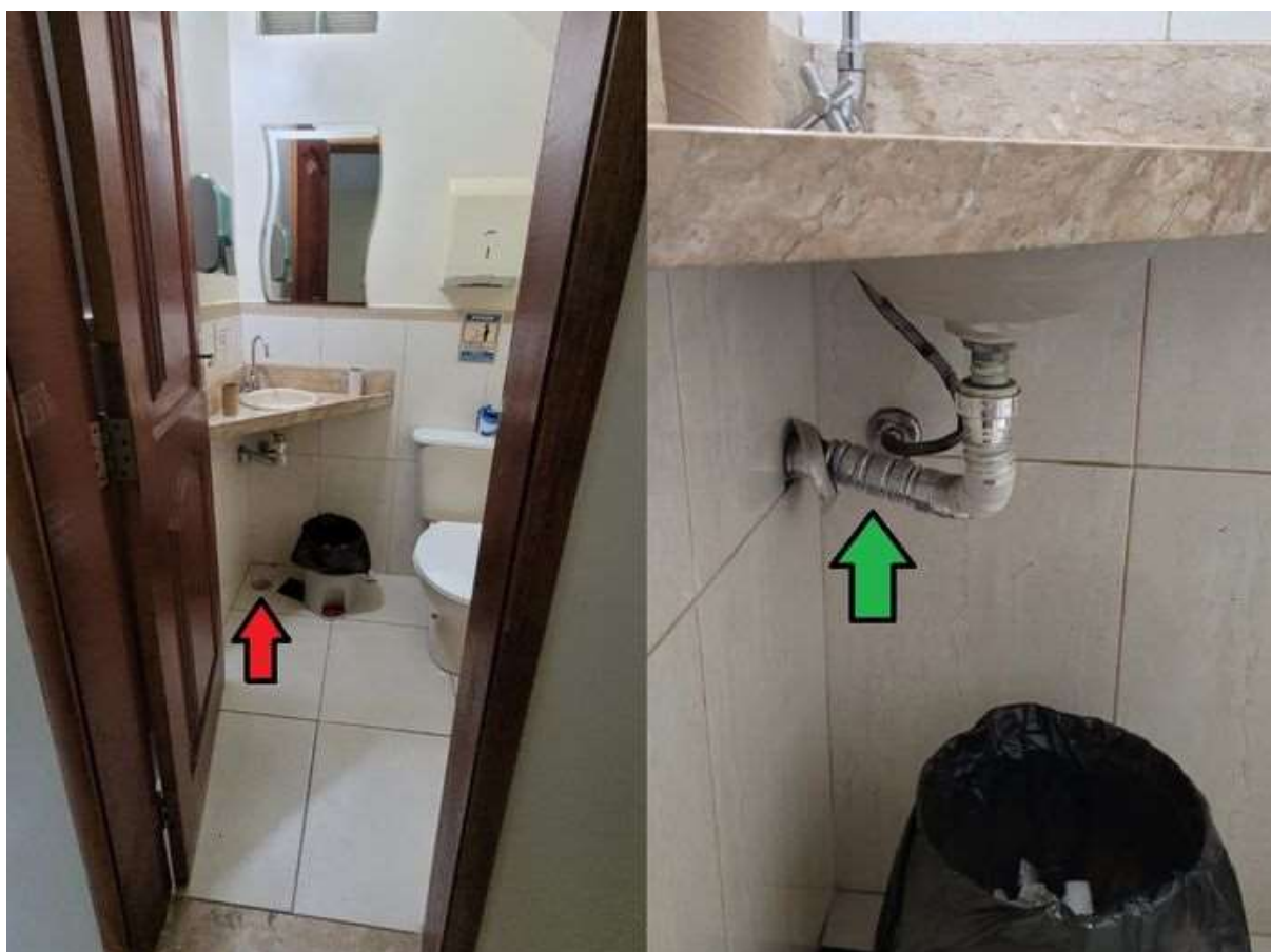
Figura 45 — Sifão sanfonado e caixa sifonado do banheiro masculino da recepção
