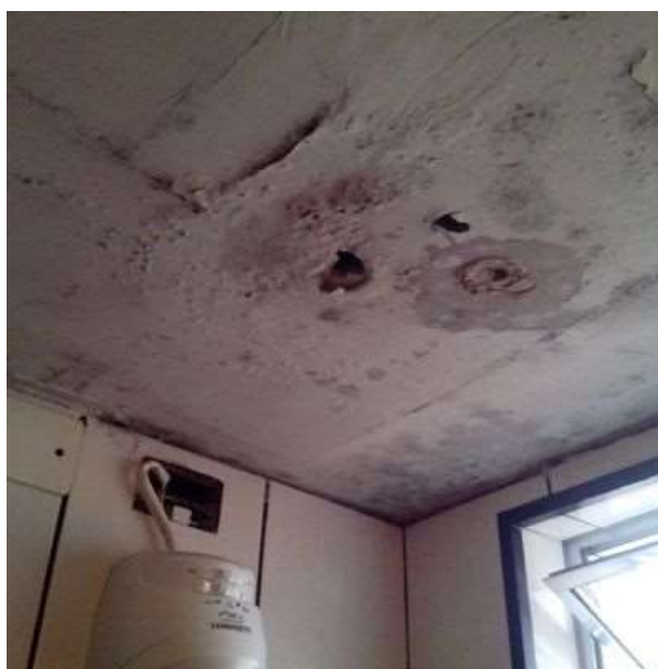
Figura 6 — Manchas de umidade em forro de gesso
