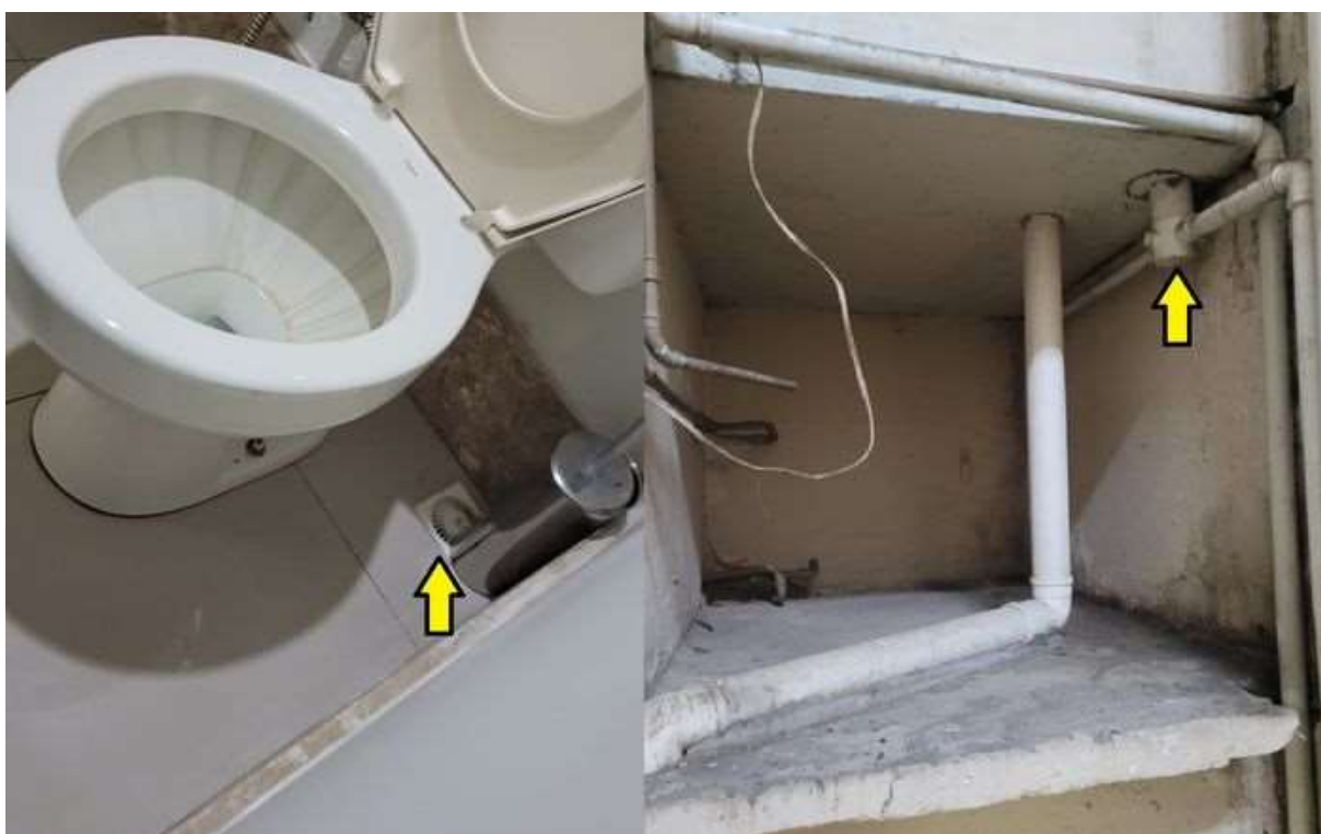
Figura 37 — Ralo sifonado banheiro da diretoria
