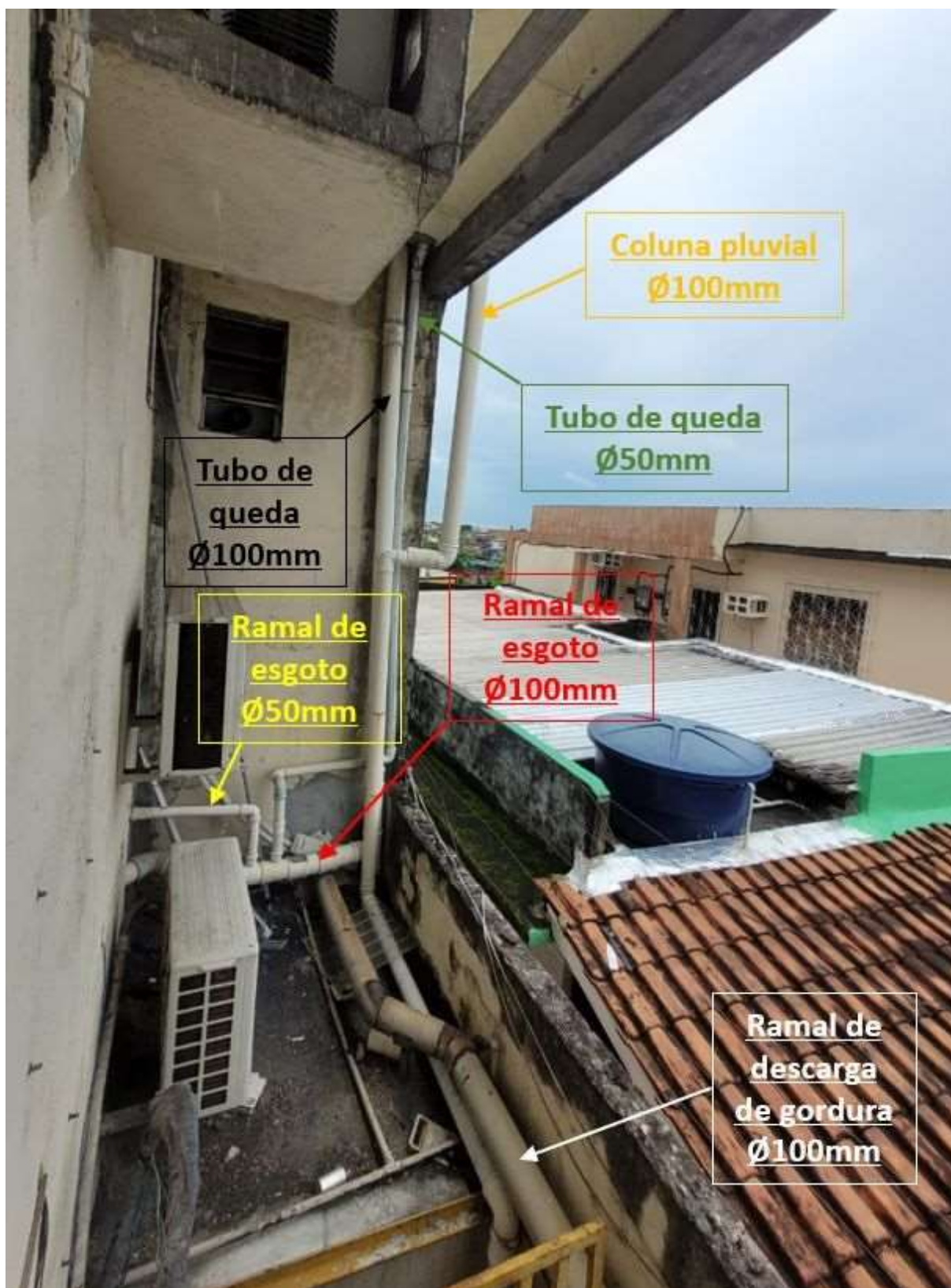
Figura 46 — Tubulações do poço de ventilação
