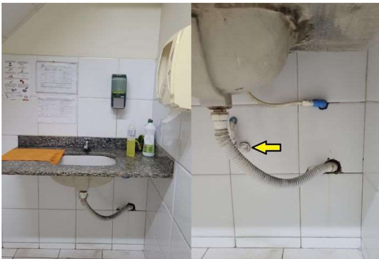
Figura 38 — Falta de um "cap" na pia da copa do primeiro pavimento
