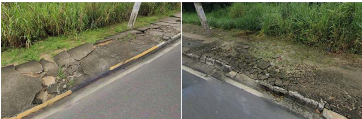
Figura 44 - Calçadas em mau estado de conservação Fonte: Google Earth, 2020
