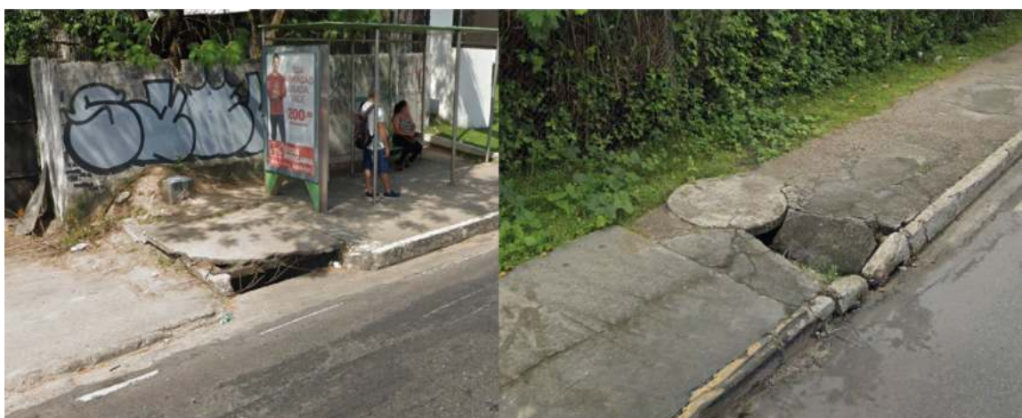
Figura 43 - Bocas de lobo em mau estado de conservação Fonte: Google Earth, 2020
