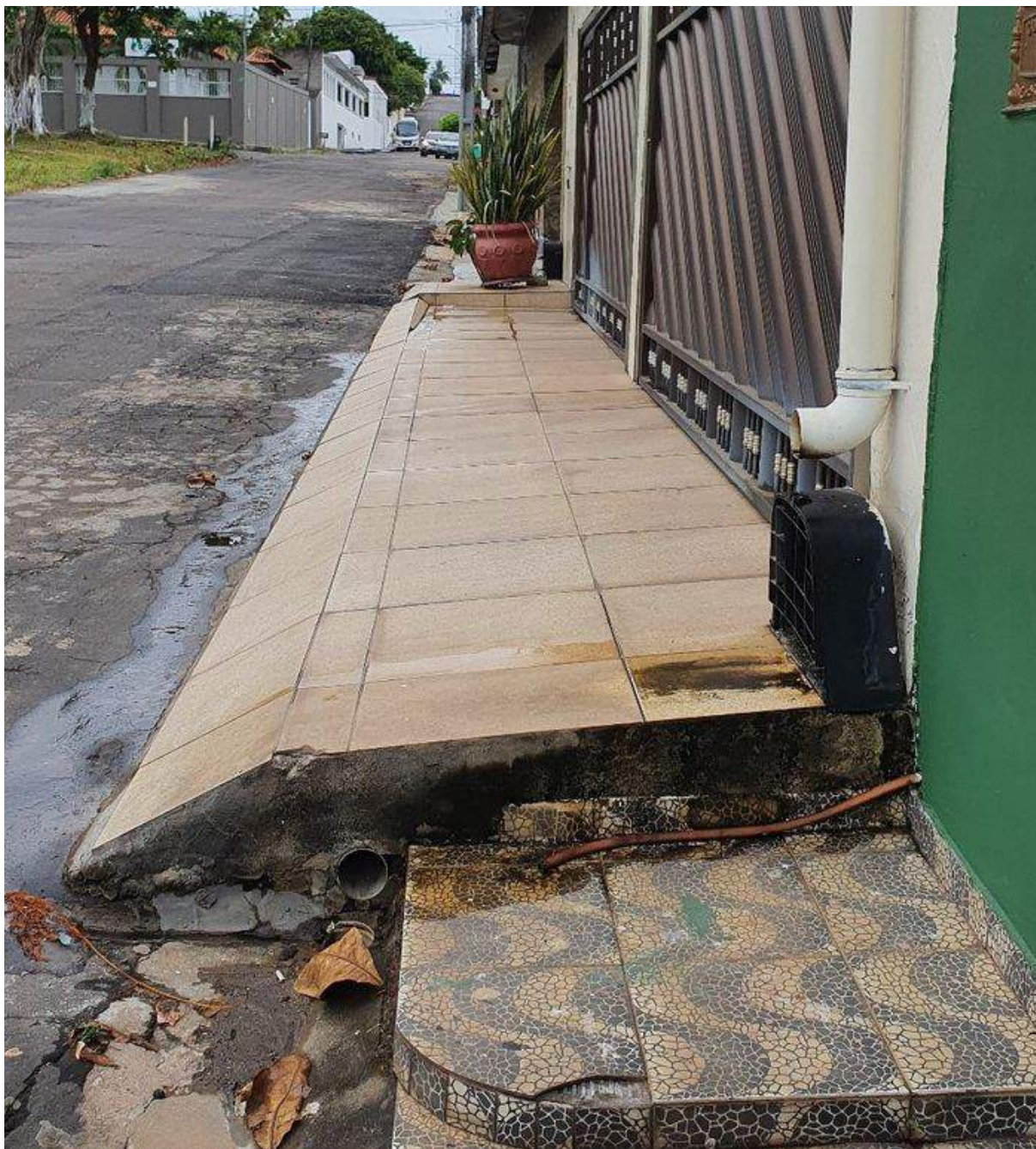
Figura 16 — Rua B, via local. Matragem irregular da calçada
