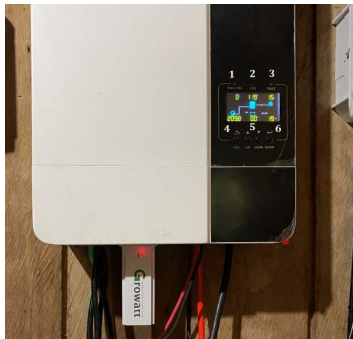
Figura 35 – Funcionamento do inversor com dados de geração solar.
