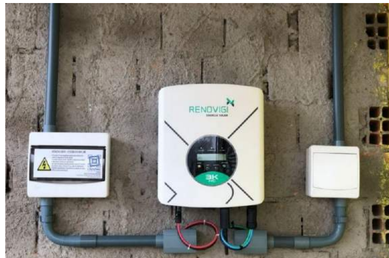
Figura 10 – Inversor de frequência.
