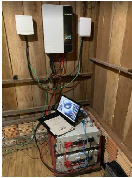
Figura 33 – Sistema Fotovoltaico funcionando sem baterias.
