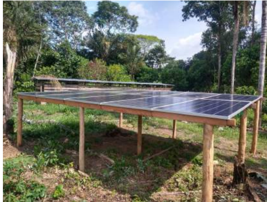
Figura 30 – Painéis fotovoltaicos instalados na base.
