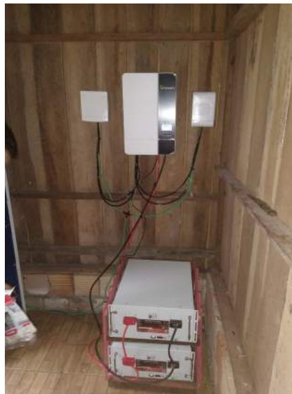
Figura 32 – Inversor com controlador, quadros e baterias conectados.
