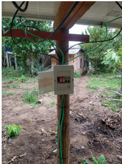
Figura 31 – String Box do Sistema Fotovoltaico.
