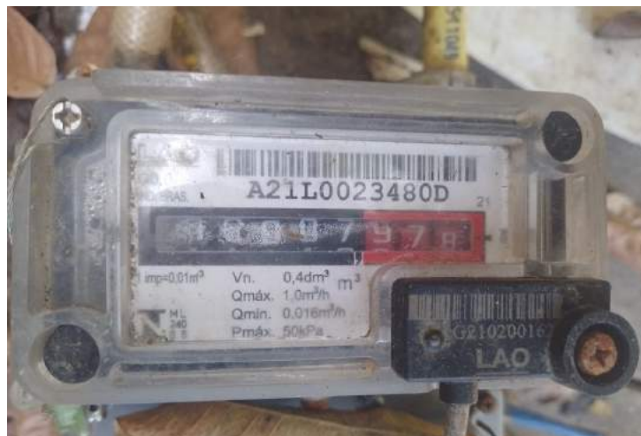
Figura 37 – Medidor de gás do sistema do biodigestor.
