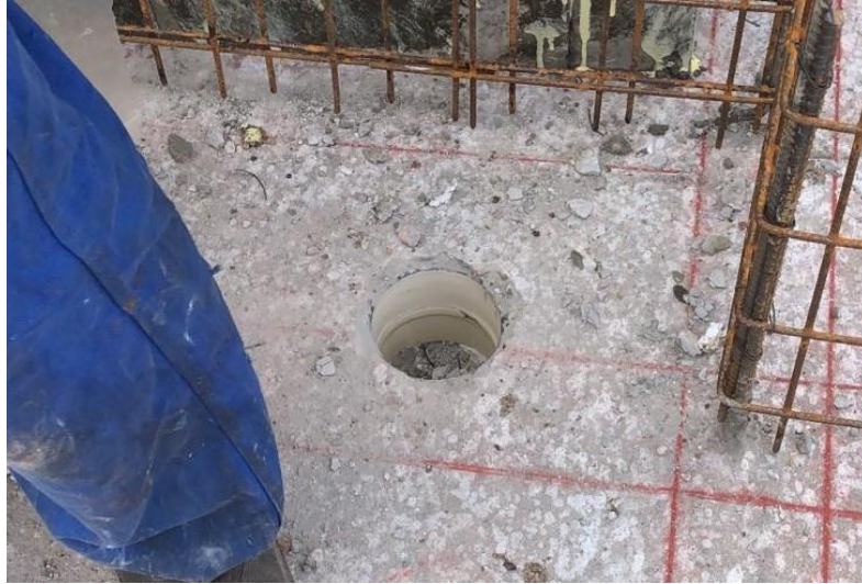
Figura 13 – Furo na laje para a tubulação de esgoto, popularmente chamado de passante.
