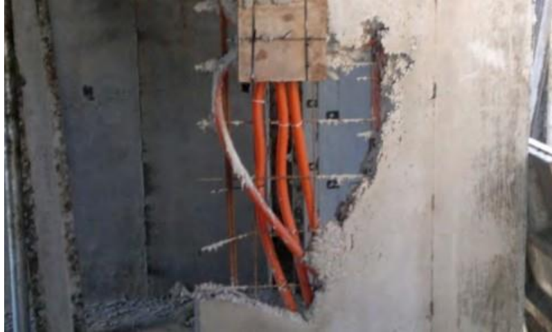
Figura 12 – Exemplo de “ninhos de concretagem”, expondo os eletrodutos da instalação elétrica.
