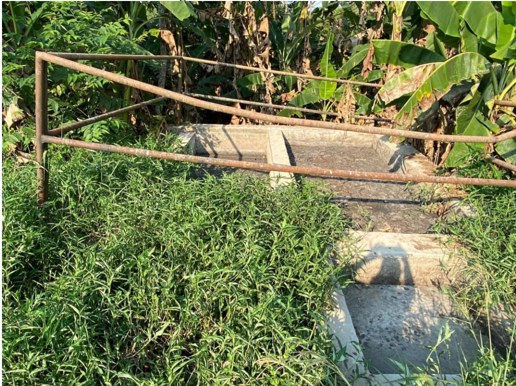
Figura 20 - Tanque de decantação
