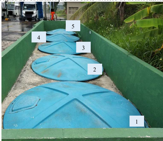
Figura 23: Identificação dos reservatórios de abastecimento
