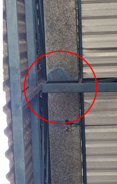
Figura 19: Incompatibilidade entre a posição prevista para um condutor vertical, do sistema de drenagem pluvial, e da tesoura do sistema estrutural da cobertura
