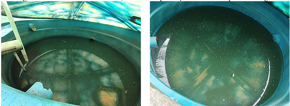
Figura 37: Interior dos reservatórios, indicando a presença de bolha na superfície da água
