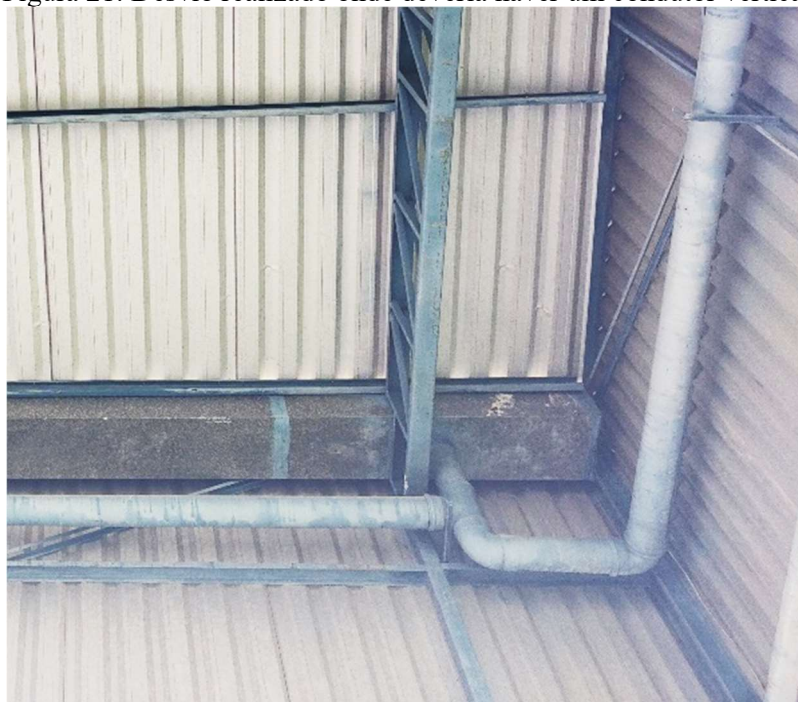
Figura 21: Desvio realizado onde deveria haver um condutor vertical
