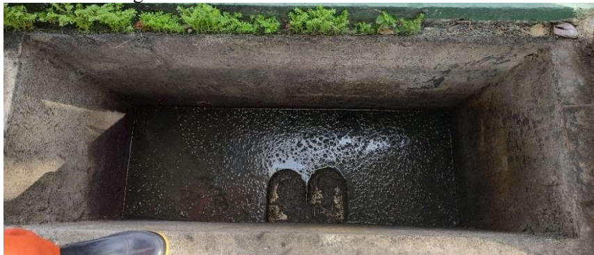
Figura 33: Interior das câmaras de tratamento
