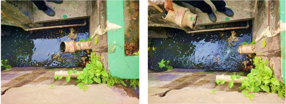
Figura 35: Detalhe do dispositivo de descarte da água de reuso, com e sem o joelho
