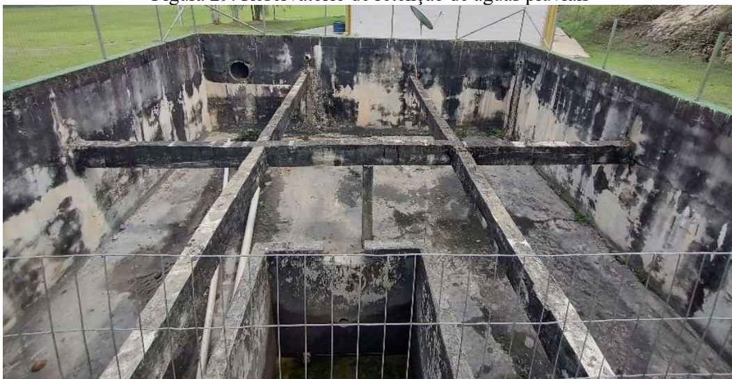
Figura 29: Reservatório de retenção de águas pluviais
