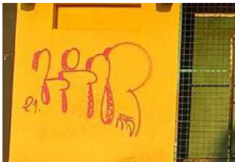
Figura 73 - Presença de Vandalismo.
