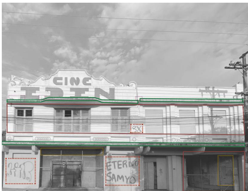
Figura 66 - Análise das Patologias. Fonte: Acervo do Autor.
