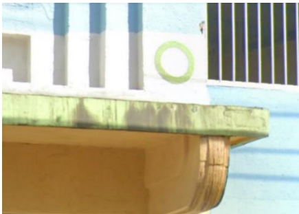
Figura 71 - Presença de Sujidades.
