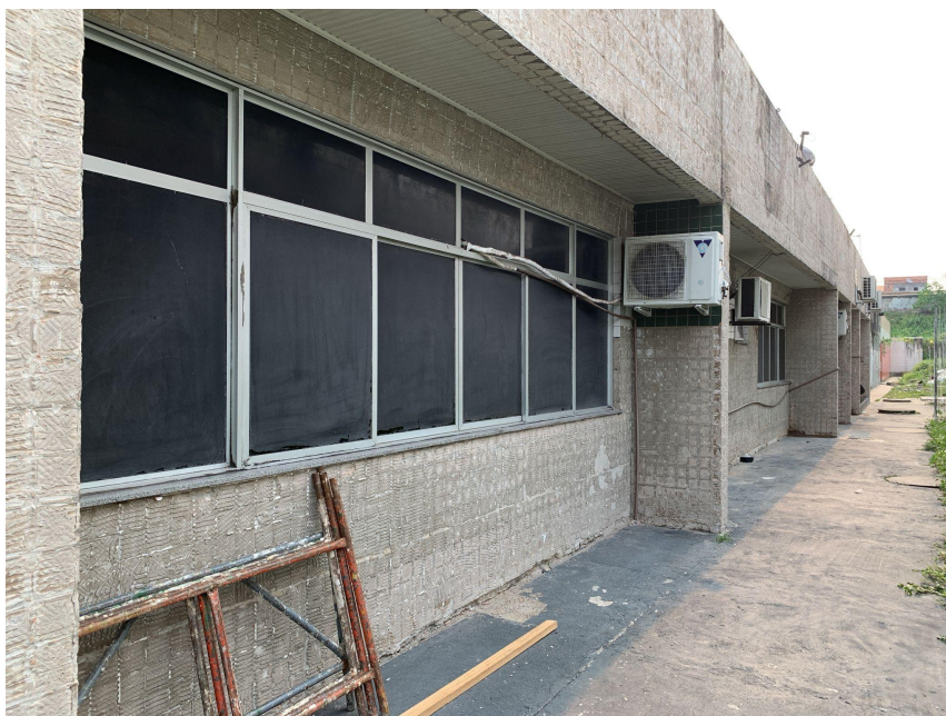
Figura 5 - Área com revestimento retirado
