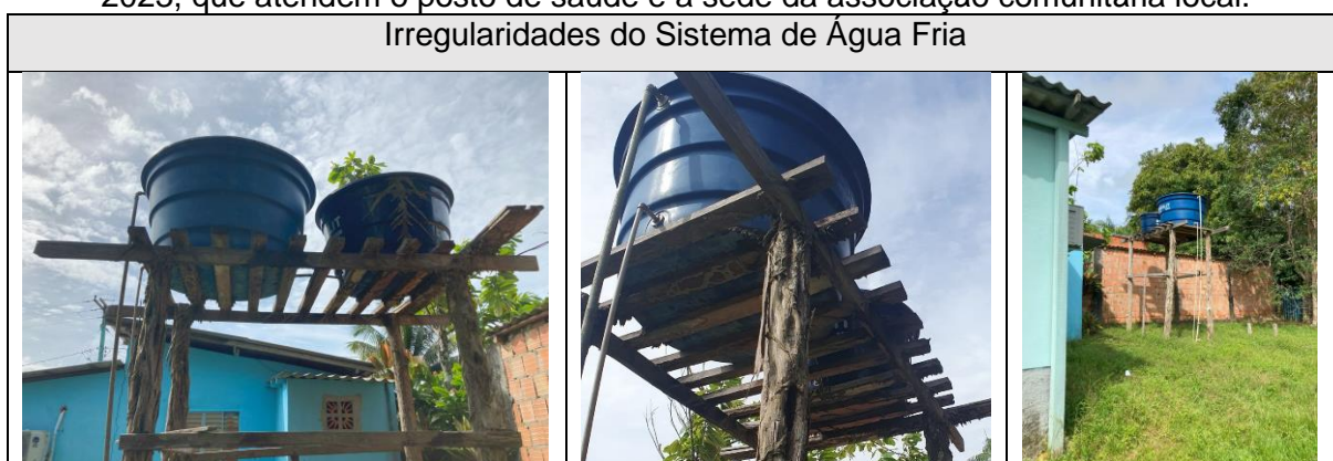
Figura 16: Reservatórios do sistema predial de AF do centro comunitário São João, em 2023, que atendem o posto de saúde e a sede da associação comunitária local.
