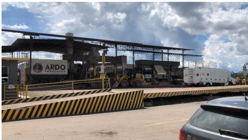
Figura 05: Usina de massa asfáltica.
