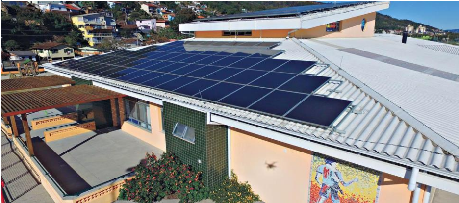
Figura 2-Placas fotovoltaicas no telhado da creche.
