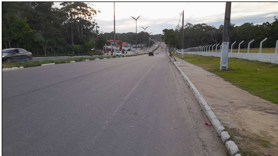
Figura 19 - Desgaste das marcas no pavimento na ciclofaixa da Av. Nathan Xavier
