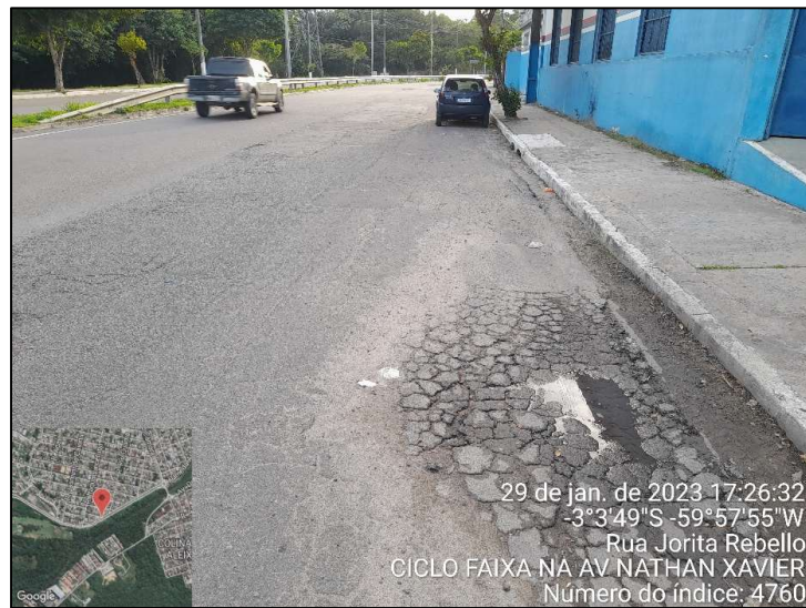
Figura 16 - Trinca interligada do tipo couro de jacaré
