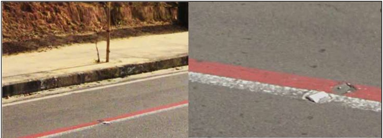
Figura 18 - Tacha retro refletiva danificada em ciclofaixa da Av. Nathan Xavier
