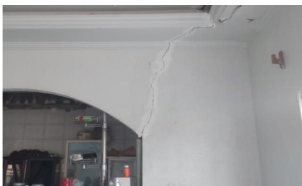
Figura 4 — Fissura na extensão de parede interna
