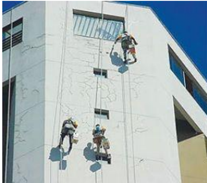
Figura 1 - Fissuração ocasionada por retração de secagem das argamassas
