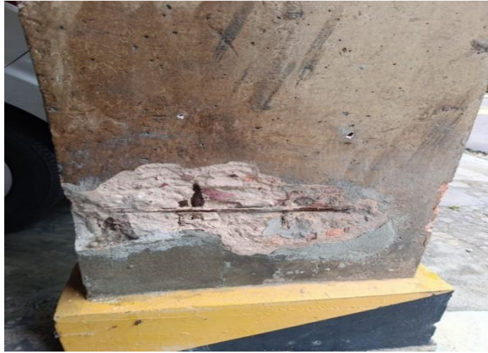
Figura 28 - Pilar 45 – Carbonatação (Fi =3), cobertura deficiente (Fi =3), corrosão (Fi = 2) e deslocamento (Fi =4)
