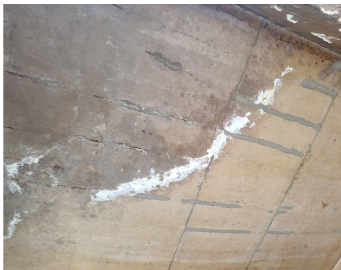
Figura 39 - Laje 25 – Deslocamento (Fi=3), eflorescência (Fi=3), e infiltração (Fi=3) e manchas (Fi=2)
