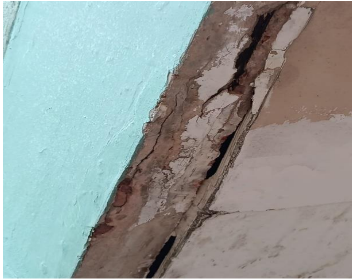
Figura 30 - Viga 2 - Corrosão (Fi=2) e deslocamento (Fi=3)
