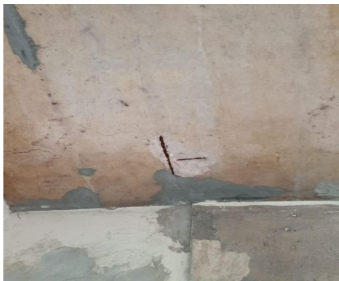
Figura 22 - Laje 16 – Carbonatação (Fi=2), Cobrimento deficiente (Fi=2) e corrosão (Fi=2), e deslocamento (Fi=3)
