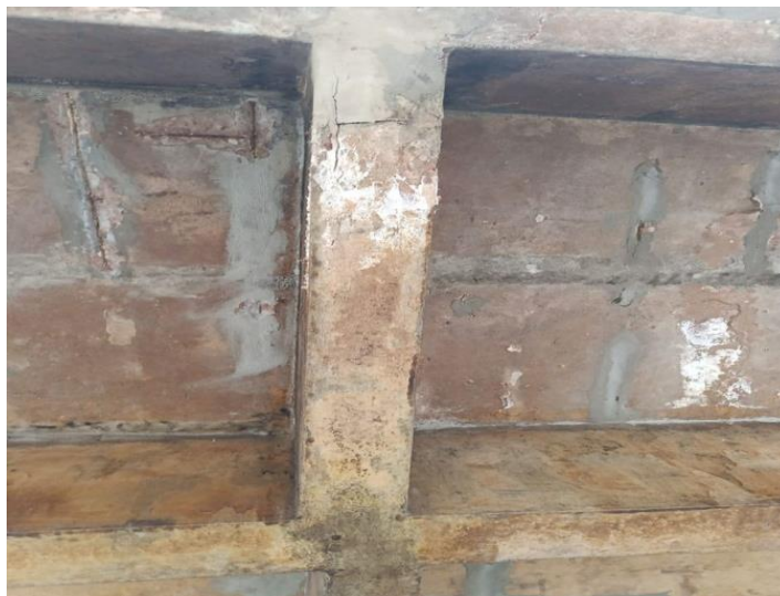
Figura 18 - Viga 14 - Eflorescência (Fi=3), deslocamento (Fi=2) e corrosão de armadura (Fi=2) na laje 15
