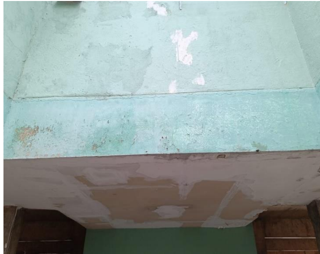
Figura 34 - Viga 31 – Infiltração ( F_i = 3 )
