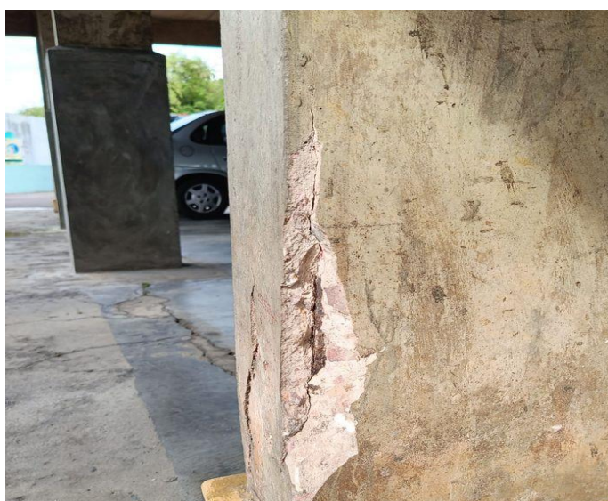
Figura 11 - Pilar 4 - Carbonatação ( F_i=3 ), Corrosão ( F_i= 2 ) e Desplacamento ( F_i= 3 )
