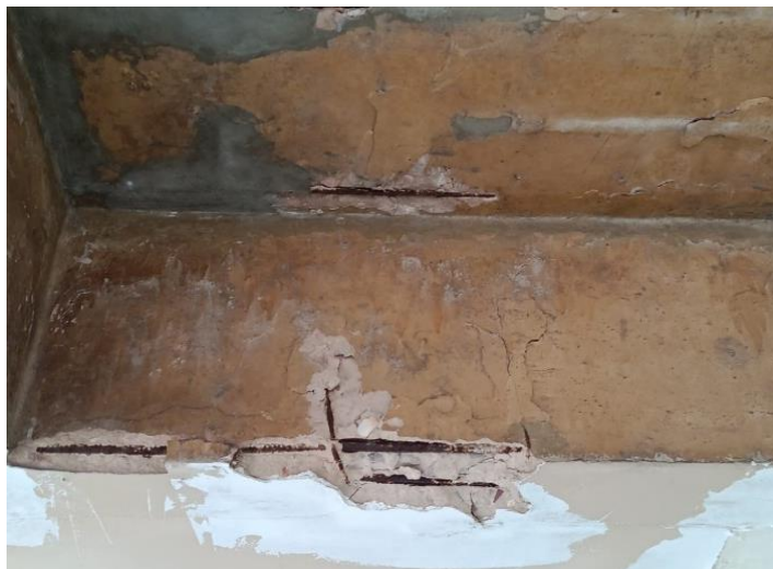
Figura 31 - Viga 2 - Carbonatação (Fi =3), cobertura deficiente (Fi=3), Corrosão (Fi=3) e deslocamento (Fi=3)
