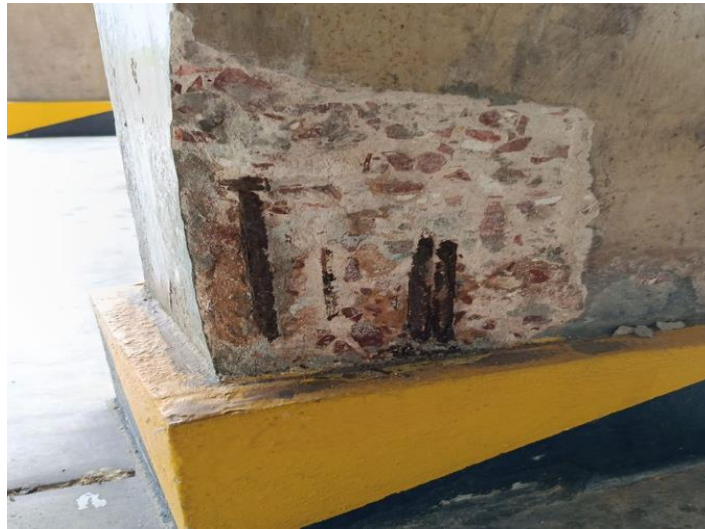
Figura 14 - Pilar 18 – Carbonatação (Fi=3), Corrosão (Fi=3) e Desplacamento (Fi=4)
