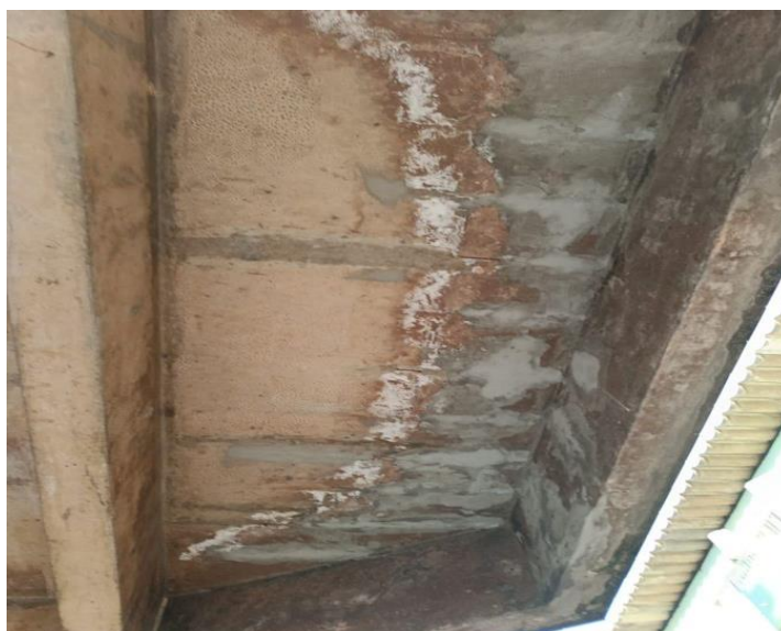
Figura 21 - Varanda da Laje 13 – Eflorescência ( Fi=4 ) e deslocamento ( Fi=2 )
