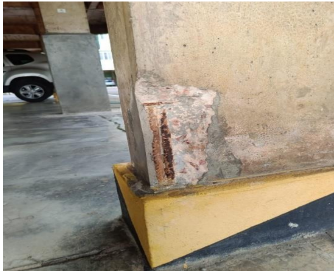
Figura 15 - Pilar 23 – Carbonatação (Fi=3), Corrosão (Fi=3) e deslocamento (Fi=3)
