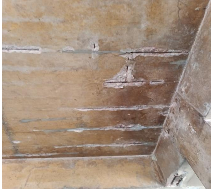
Figura 37 - Laje 8 - Carbonatação (Fi=4), cobertura deficiente (Fi=3), corrosão (Fi=4), eflorescência (Fi=3), deslocamento (Fi=4). infiltração (Fi=3) e manchas (Fi=2)
