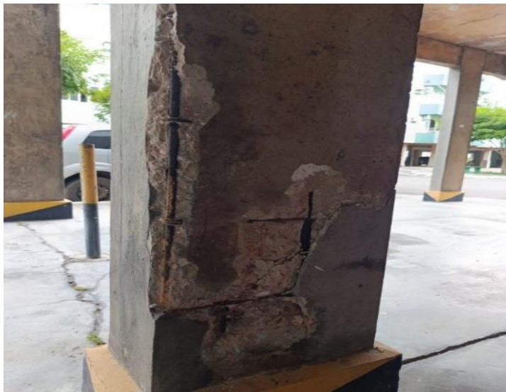
Figura 27 - Pilar 38 – Carbonatação (Fi=3), corrosão (Fi=4) e deslocamento (Fi=4)
