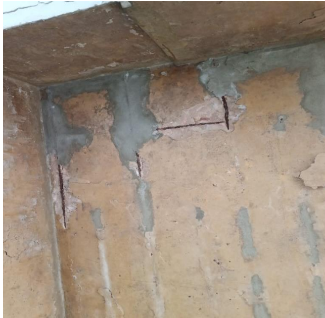
Figura 38 - Laje 11 - Carbonatação (Fi=2), cobertura deficiente (Fi=3), corrosão (Fi=3) e deslocamento (Fi=3)
