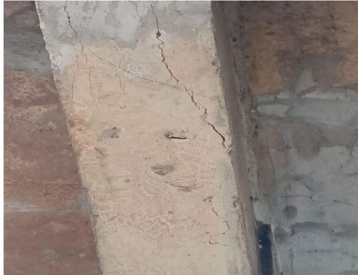
Figura 19 - Viga 15 - Fissuras (Fi=2)
