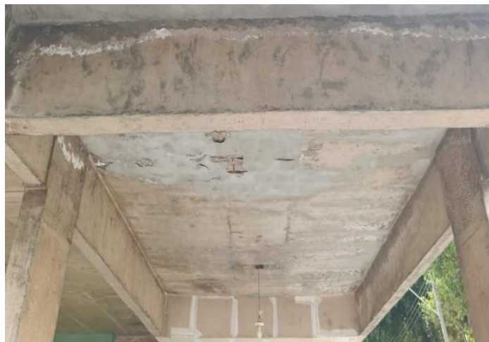
Figura 29 - Viga 1 - Eflorescência (Fi=3)
