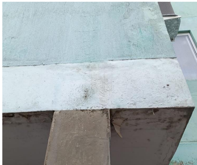
Figura 35 - Viga 33 - Infiltração ( F_i = 2 )
