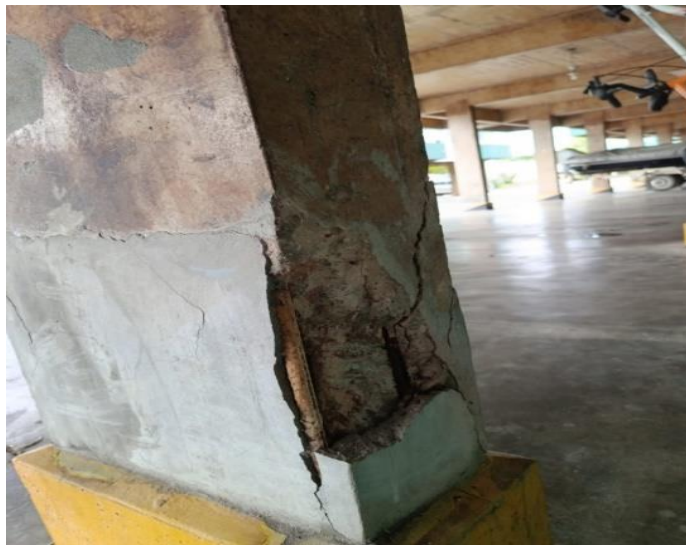
Figura 25 - Pilar 16 – Carbonatação ( Fi=3 ), cobrimento deficiente ( Fi=3 ), Corrosão ( Fi=4 ) e Desplacamento ( Fi=4 )
