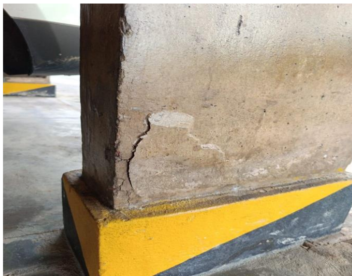
Figura 16 - Pilar 25 - Desplacamento (Fi = 2)
