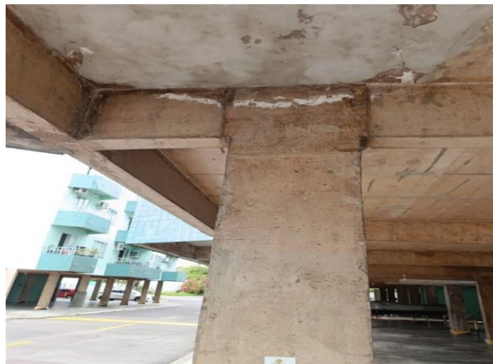
Figura 24 – Pilar 2 – Eflorescência (Fi=3)
