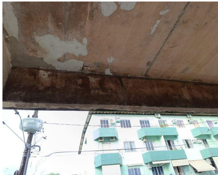
Figura 20 - Viga 20 - Manchas (Fi=3) e Laje 18 - Corrosão (Fi=2)
