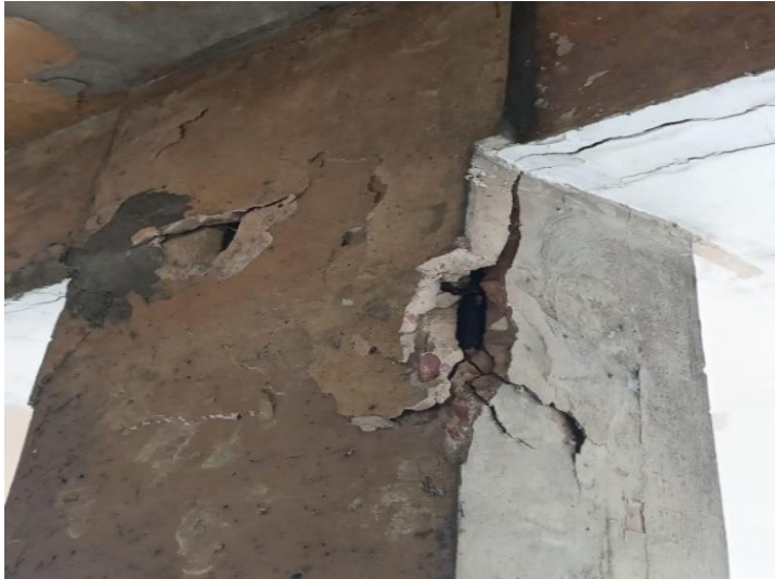
Figura 26 - Pilar 25 - Carbonatação (Fi=3), corrosão (Fi=3) e deslocamento (Fi=4)
