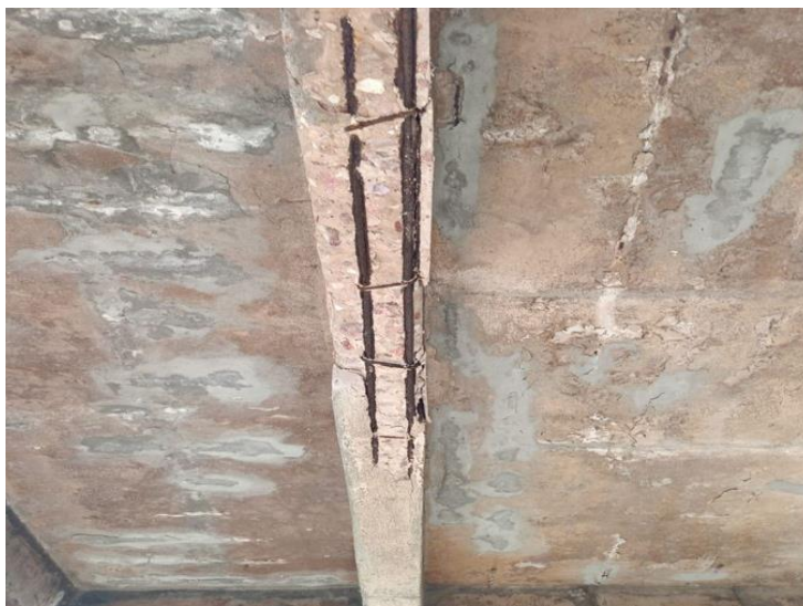
Figura 17 - Viga 1 - Carbonatação ( F_i = 4 ), Cobrimento deficiente ( F_i = 3 ), Corrosão ( F_i = 3 ) e deslocamento ( F_i = 4 )
