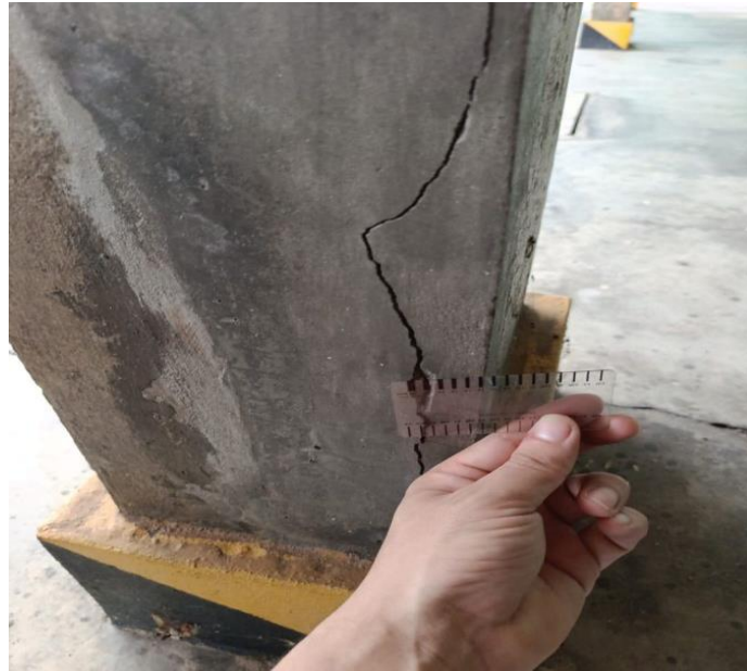
Figura 12 - Pilar 13 - Desplacamento ( F_i = 3 )
