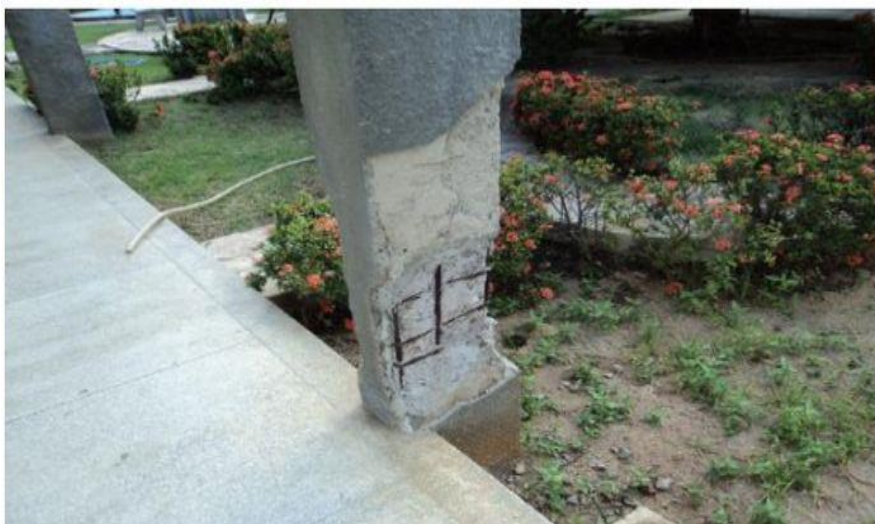
Figura 6 - Cobrimento inadequado do pilar
