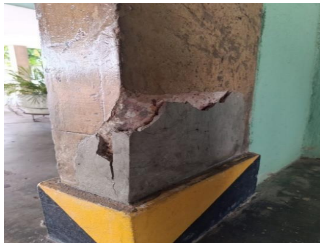
Figura 13 - Pilar 16 - Carbonatação ( F_i=3 ), Corrosão ( F_i= 3 ) e Desplacamento ( F_i= 3 ).
