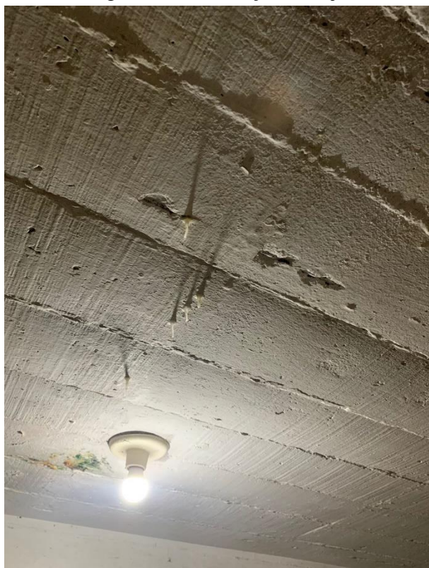
Figura 4 – Lixiviação da laje
