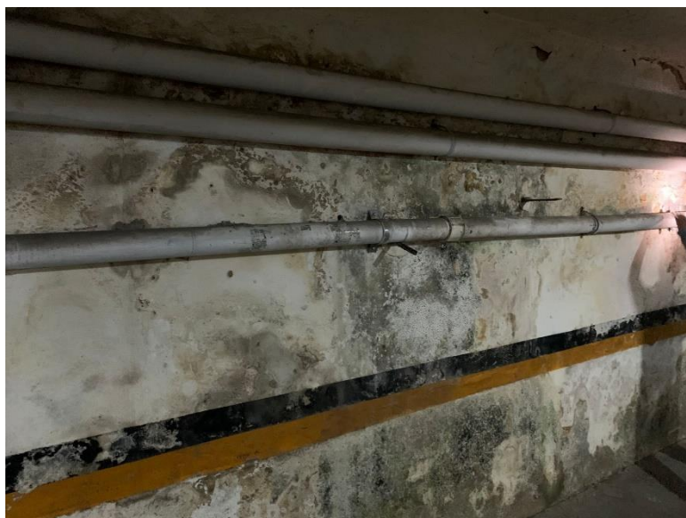
Figura 7 – Bolor nas paredes do estacionamento
