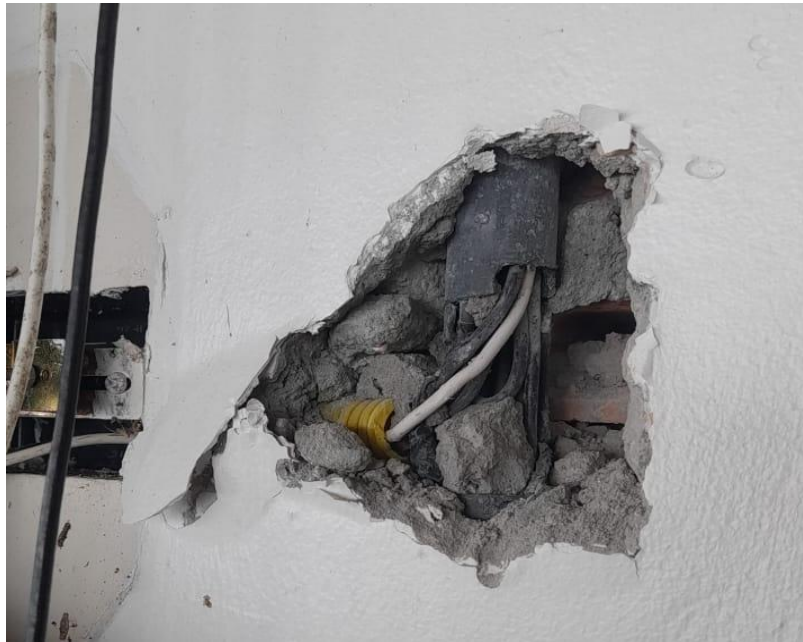
Figura 13. Eletroduto obstruído com argamassa.
