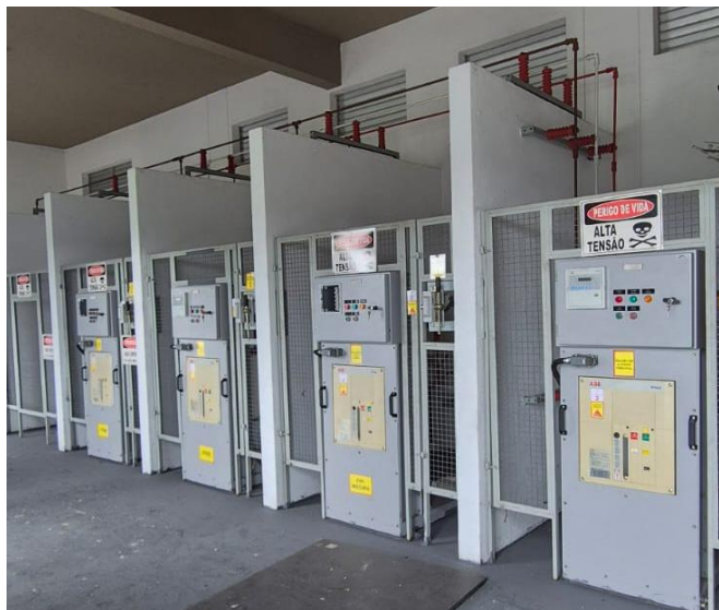
Figura 06: Foto da Subestação 01.
